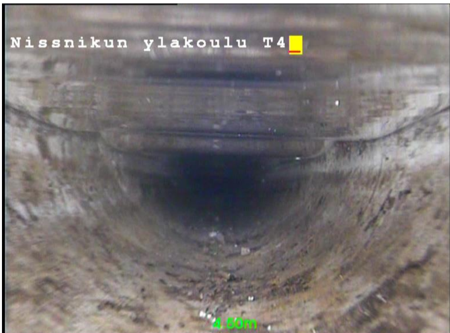
Tuuletusviemärin vaakaosuudella runsaasti vettä (T4).
