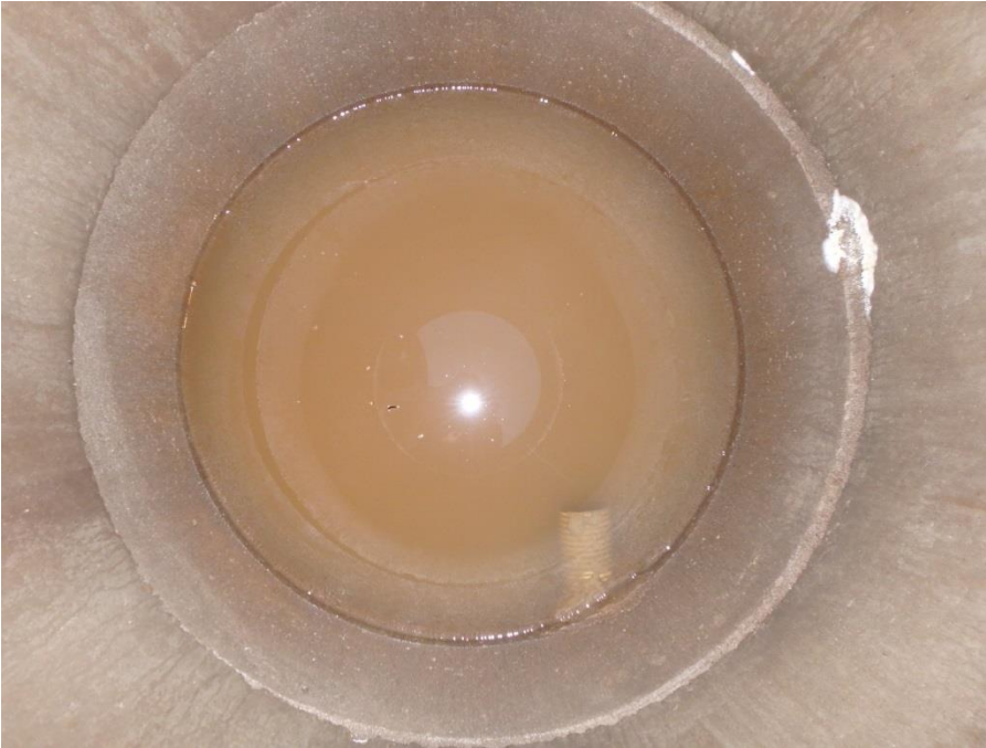
Salaojaputki kokonaan veden alla kaivossa.
