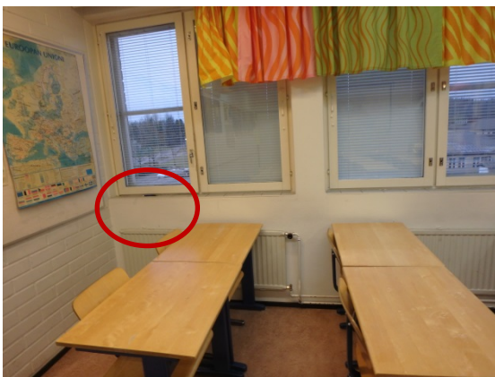
Kuva 28. Koira ilmaisi ikkunapenkin ja ikkunan liitokseen.
