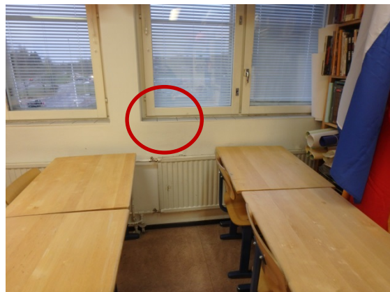
Kuva 29. Koira ilmaisi ikkunapenkin ja ikkunan liitokseen.
