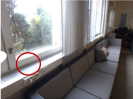
Kuva 20. Koira ilmaisi ikkunanapenkin ja ikkunan liitokseen.
