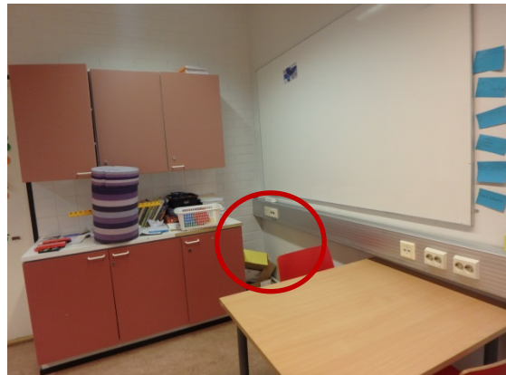
Kuva 25. Koira ilmaisi väli- ja ulkoseinän liitokseen.
