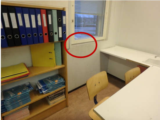
Kuva 8. Koira ilmaisi ulkoseinän ja ikkunan liitokseen.
