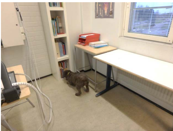
Kuva 30. Koira ilmaisi väli- ja ulkoseinän liitokseen.
