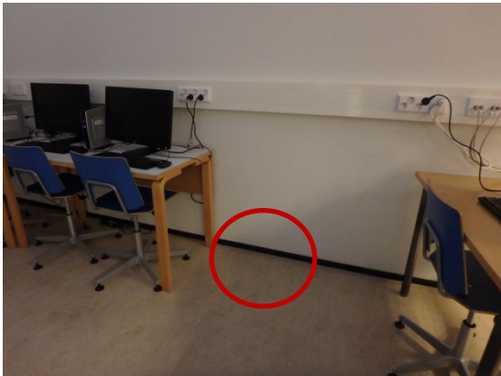
Kuva 22. Koira ilmaisi lattian ja seinän liitokseen.
