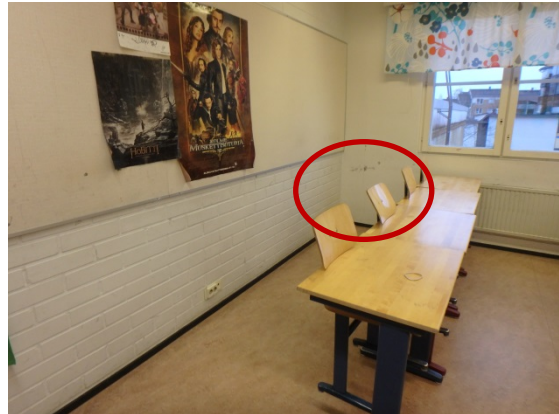
Kuva 23. Koira ilmaisi ulkoseinällä.
