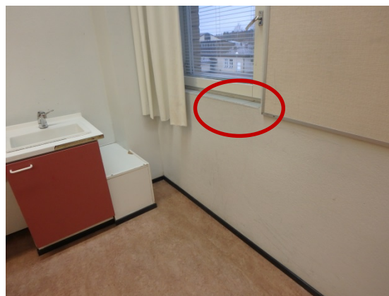
Kuva 17. Koira ilmaisi ulkoseinän ja ikkunan liitokseen.
