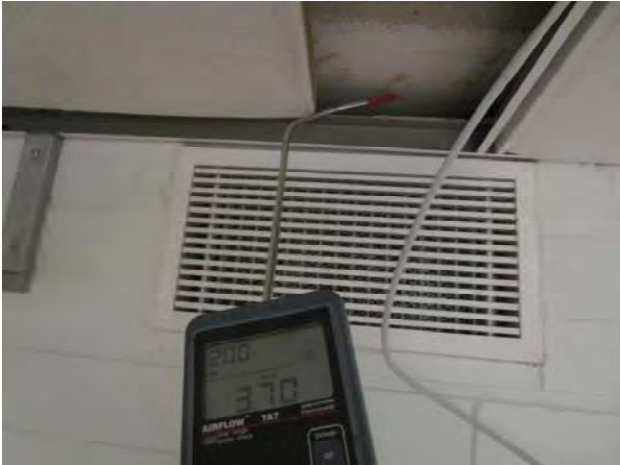
Kuvat 218-220: Vuotoilmavirtauksia väliseinän ja yläpohjan liitoksesta. Alaslasketun kattoverhouksen yläpuolella on ilmayhteys väliseinän yli seinän takana olevaan tekniikkakuiluun. (79)
