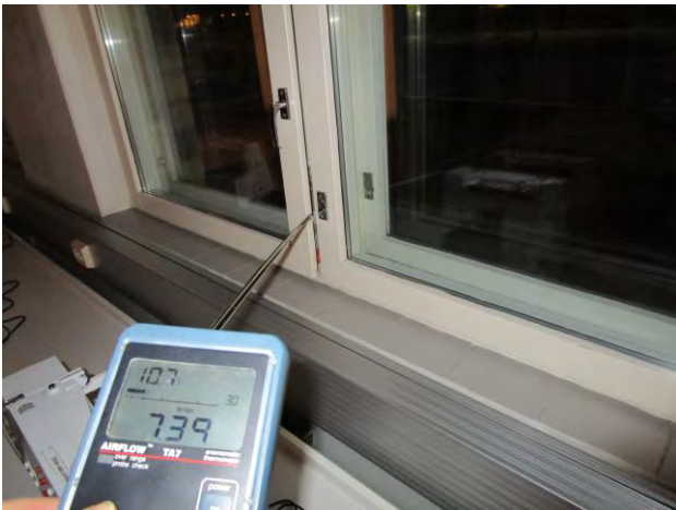
Kuvat 43-45: Vuotoilmavirtauksia ikkunan karmin ja puitteen välistä (16)
