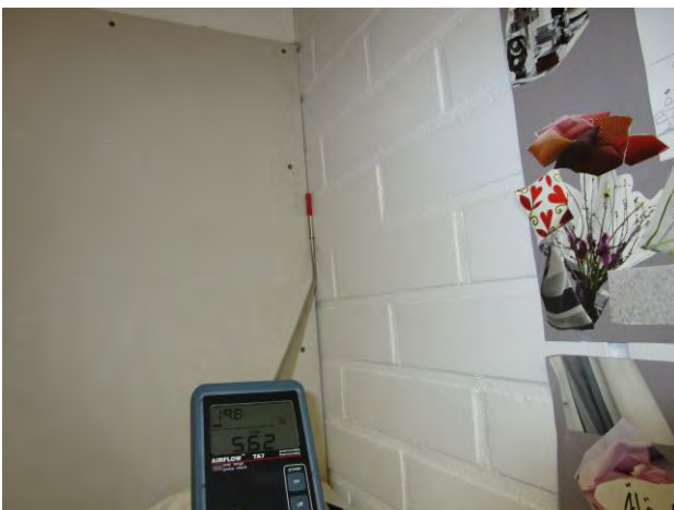
Kuvat 38-40: Vuotoilmavirtauksia kotelo-oviverhouslevyn takaa (14)
