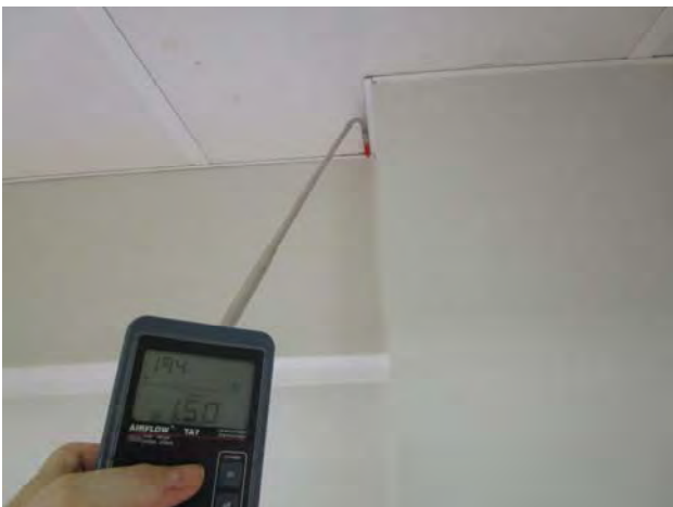
Kuvat 221-223: Vuotoilmavirtauksia kotelorakenteen ja alaslasketun kattoverhouksen liitoksesta (80)
