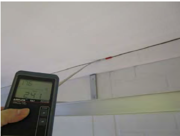
Kuvat 129-131: Vuotoilmavirtauksia ulkoseinien sisänurkan liitoksessa yläpohjaan (47)
