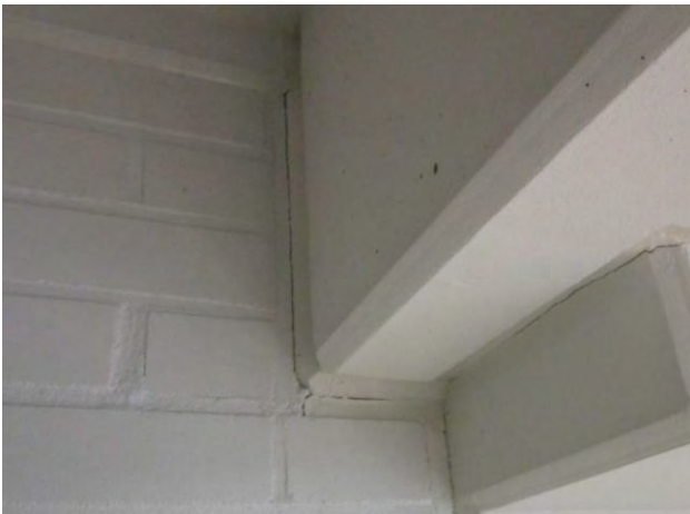
Kuvat 15-17: Vuotoilmavirtauksia betonipalkin ja tiiliverhouksen liitoksessa olevasta halkeamasta (5)
