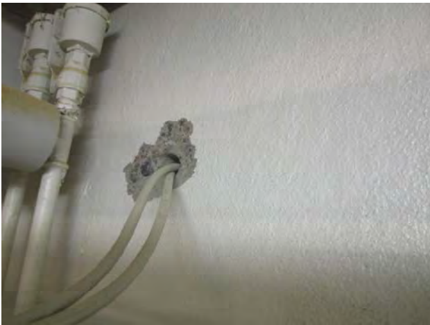
Kuvat 237-239: Vuotoilmavirtauksia ulkoseinään kaapeleille tehdystä läpiviennistä (86)
