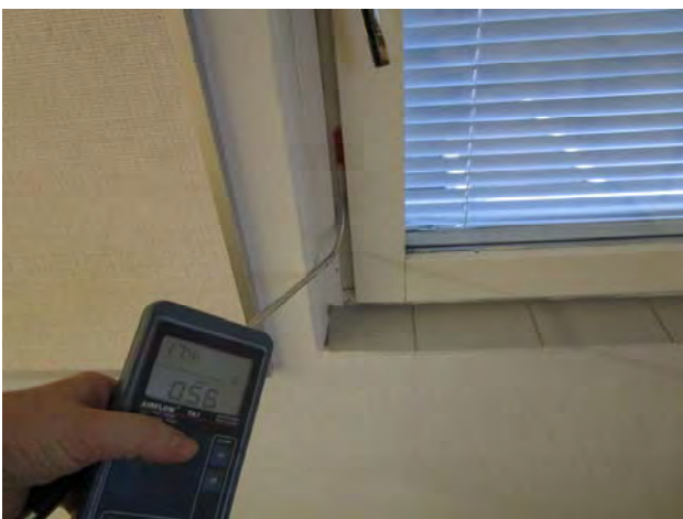
Kuvat 199-201: Vuotoilmavirtauksia ikkunan karmin ja puitteen välistä (73)
