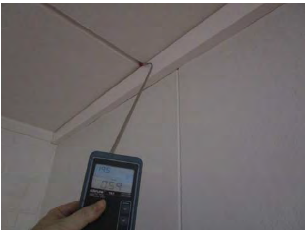
Kuvat 150-152: Vuotoilmavirtauksia ulkoseinän ja yläpohjan liitoksesta (55)
