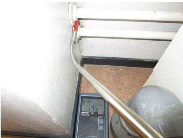
Kuvat 12-14: Vuotoilmavirtauksia pystykotelosta rakenneliitosten ja verhouslevyyn lämpöputkille tehtyjen läpivientien kautta (4)
