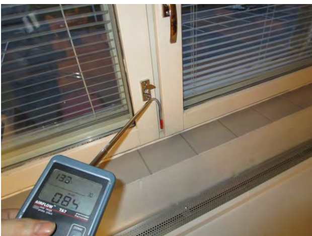
Kuvat 63-65: Vuotoilmavirtauksia ikkunan karmin ja puitteen välistä (22)
