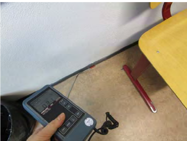
Kuvat 155-157: Vuotoilmavirtauksia ulkoseinän ja välipohjan liitoksesta (57)
