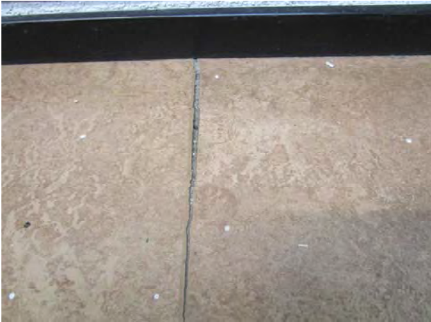
Kuvat 137-139: Vuotoilmavirtauksia välipohjan lattiapäällysteessä olevasta halkeamasta (50)
