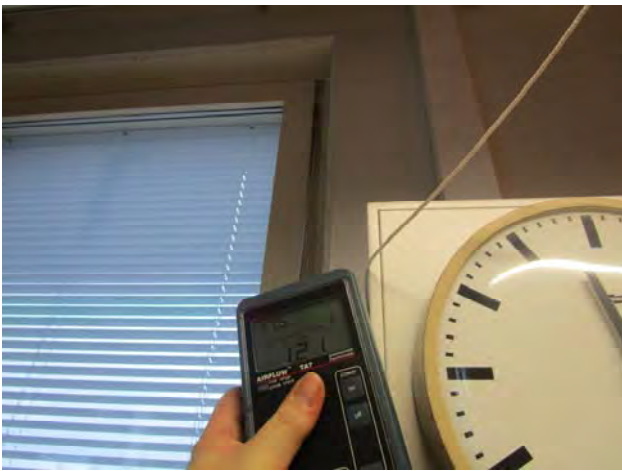
Kuvat 134-136: Vuotoilmavirtauksia ikkunan karmin ja puitteen välistä (49)
