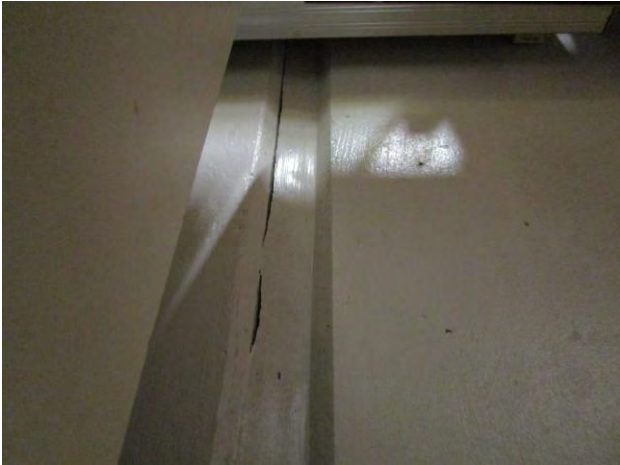
Kuvat 24-26: Vuotoilmavirtauksia betonipilarin ja seinärakenteen välisessä saumauksessa olevista halkeamista (9)
