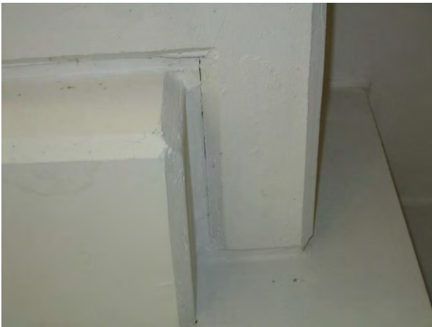
Kuvat 5-7: Vuotoilmavirtauksia kantavien betonielementtien välisen saumauksen halkeamista (2)
