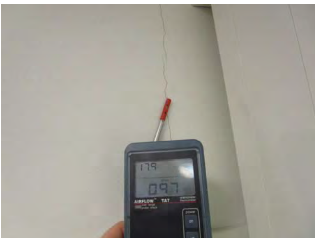
Kuvat 114-116: Vuotoilmavirtauksia ulkoseinärakenteesta olevasta halkeamasta (42)
