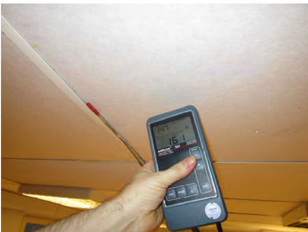
Kuvat 109-111: Vuotoilmavirtauksia kattoon liimattujen akustiikkalevyjen välisistä saumoista (40)
