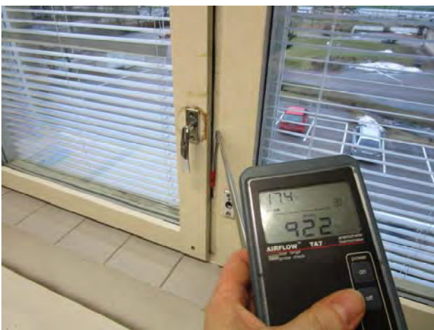
Kuvat 168-170: Vuotoilmavirtauksia ikkunan karmin ja puitteen välistä (62)
