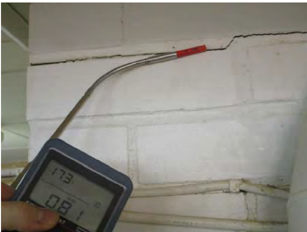
Kuvat 228-230: Vuotoilmavirtauksia huoneen 139 vastaisessa tiiliseinässä olevista halkeamista (82)
