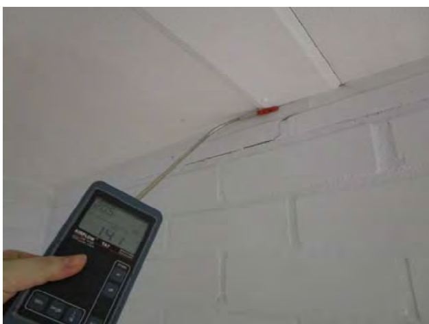
Kuvat 190-192: Vuotoilmavirtauksia yläpohjan liikuntasaumasta (70)
