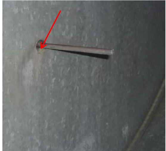
Kuva 152. IV-kone 301, raitisilmakanavan anturiläpiviennissä suojaamatonta mineraalivillaa
