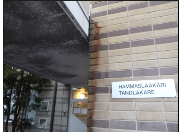
Kuva 26. Rästysrakenteet ohjaavat vettä katoilta julkisivurakenteeseen.
