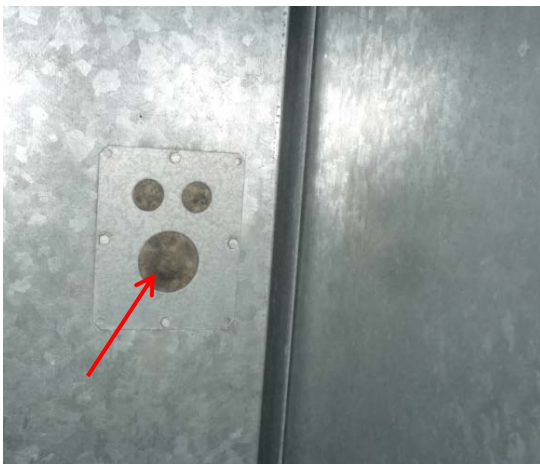
Kuva 198. IV-kone 304, tulopuhallinkammion kaapeliläpivientivarauksissa on suojaamatonta mineraalivillaa
