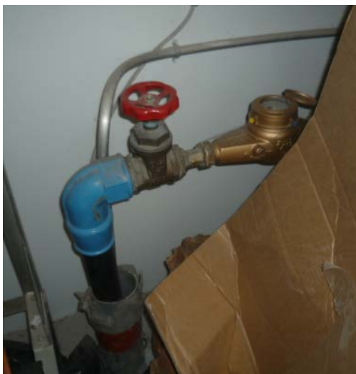
Kuva 225. Tonttivesijohto ja vesimittari
