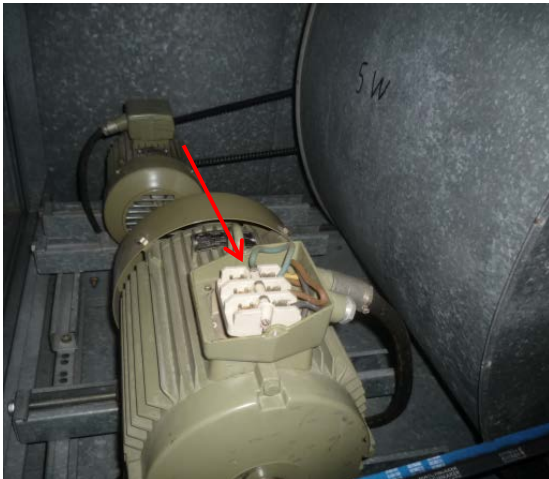
Kuva 183. IV-kone 303, tuloilmapuhaltimen moottorin kytkentäkotelon kansi on irronnut.
