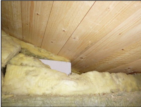
Kuva 127. Tuuletusväli on suljettu tilan 309 yläpuolella.
