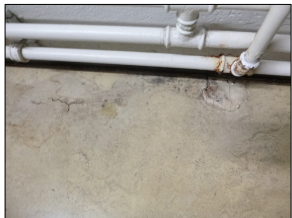
Kuva 80. Tilan 242 lattiamattoon on muodostunut putki- vuodosta kosteusvaurio.
