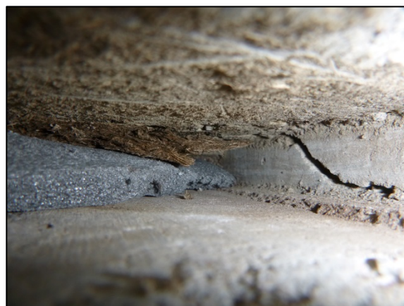
Kuva 64. Liitokohta on tiivistetty solumuovinauhalla ja liitoksen välissä on havaittavissa puukuitulevyä.
