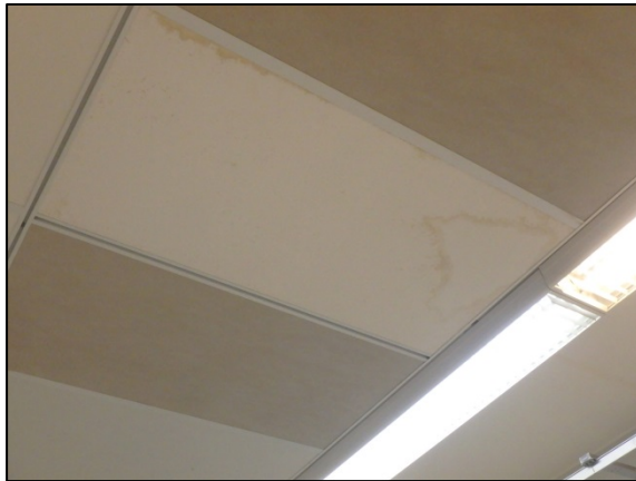
Kuva 65. Kolmannen kerroksen alakattolevyissä on useissa kohdissa kosteuden aiheuttamia jälkiä.
