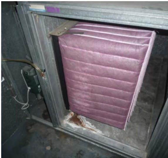
Kuva 153. IV-kone 301, tulosuodatinkammion pohjalla vanhoja kosteusjälkiä
