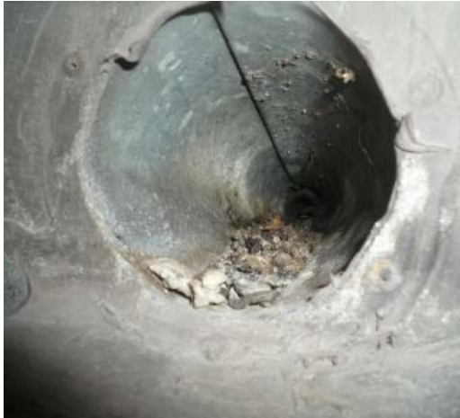
Kuva 146. IV-kone 301, ri-kanavan vedenpoistoputkeen kertynyt orgaanista materiaalia
