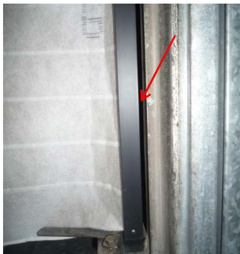
Kuva 159. IV-kone 301, poistoilmasuodattimien asennus epätiivis
