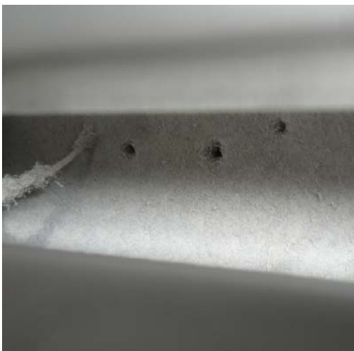
Kuva 216. Luokka 313, poistoilmapäätelaitteen sisällä oleva reikälevy on pölyntynyt miltei täysin umpeen
