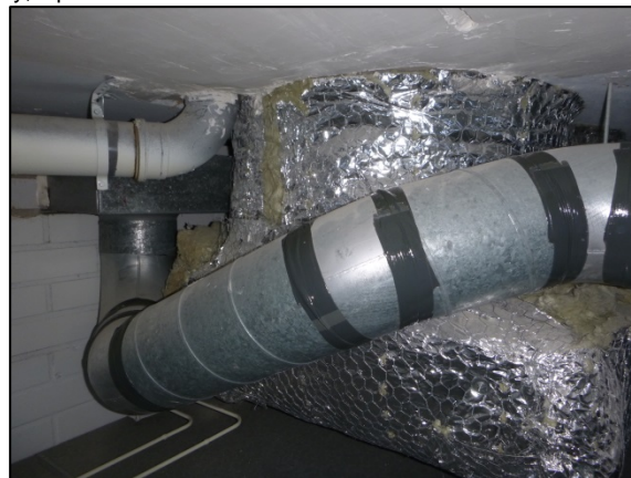
Kuva 74. Tilassa 306 olevan läpivienneistään avoimen koteloinnin sisäpuolisissa osissa on avointa mineraalivillaa.
