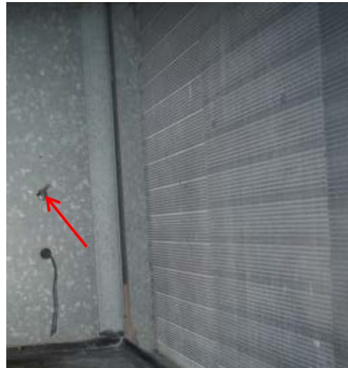
Kuva 174. IV-kone 302, tutkimusten aikana lämmityspatterit puhdistettu. Anturiläpiviennissä suojaamatonta mineraalivillaa
