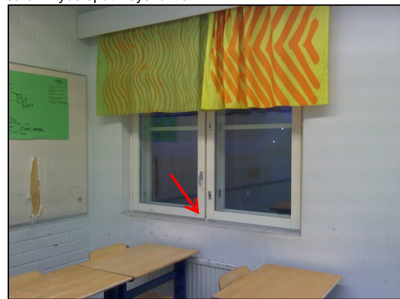
Kuva 44. Havaittu ilmavuoto puitteen tiivistyksistä.
