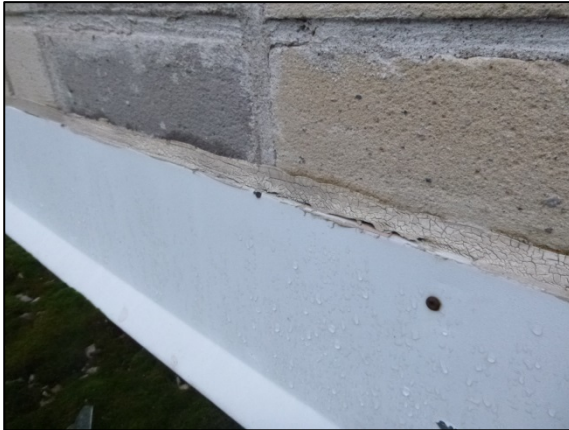
Kuva 139. Ruokalan vesikatteen ylösnostopeltien tiivistemassaukset ovat ikääntyneitä ja osin avonaisia.
