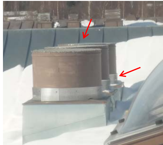
Kuva 162. Tutkimusten aikana raitisilmanottokatosten päälle ja alaosaan lisättiin suojaverkot (kuvassa koneen 302 ja 303 ilmanottokatokset)
