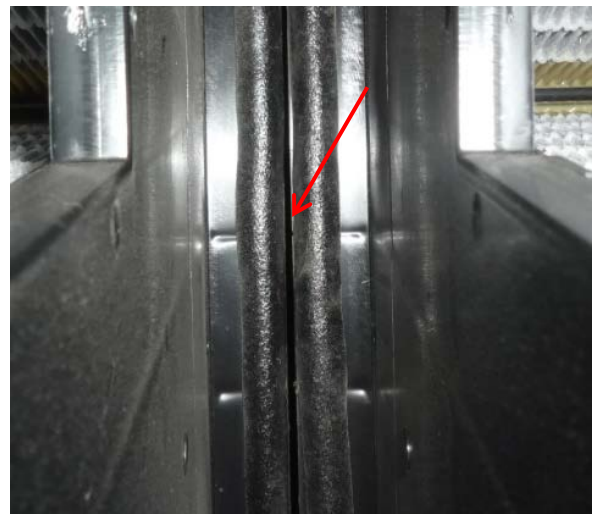
Kuva 191. IV-kone 304, tulosuodatinten kehysten välissä oli selkeä rako ensimmäisessä tarkastuksessa. Kehysten sivussa ei ole tiivisteitä
