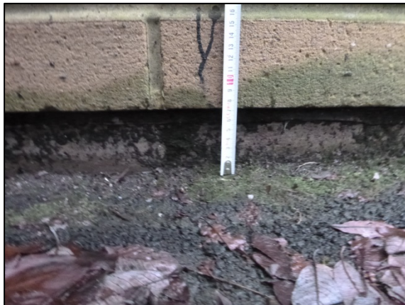
Kuva 27. Ulkoseinäelementin alaosa on lähellä asfaltoitua maanpintaa.
