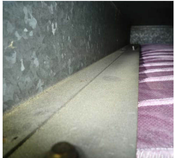
Kuva 154. IV-kone 301, tulosuodattimien kiristysmekanismin peltireunuksen päällä siitepölyä
