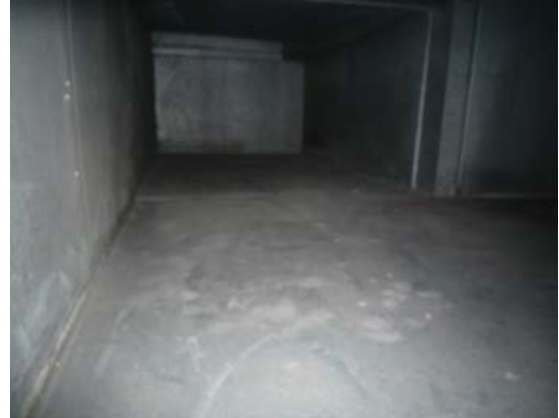
Kuva 180. IV-kone 303, raitisilmakanava puhdistettu tutkimusten aikana
