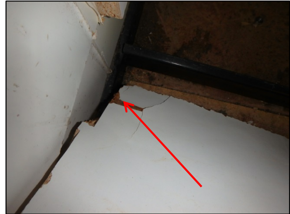
Kuva 82. Toisen kerroksen luokkatiloissa olevien pesuallas-kaapistojen lattiaa vasten olevissa levytyksissä on kosteusvaurioita.
