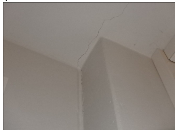
Kuva 68. Välipohjarakenteissa on useissa kohdissa halkeamia.
