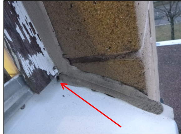
Kuva 42. Ulkopuoliset kittaukset ovat ikääntyneet. Kittauksissa on myös epätiivisyyskohtia.
