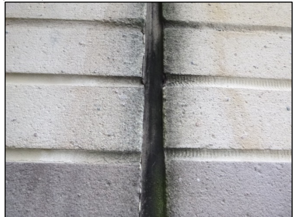
Kuva 30. Elementtisaumat ovat ikääntyneet.
