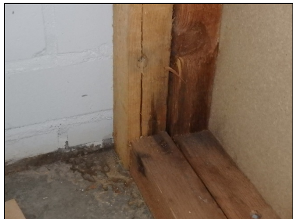
Kuva 88. Koteloinnin käytävän puoleisissa osissa on kosteuden aiheuttamia vaurioita,
