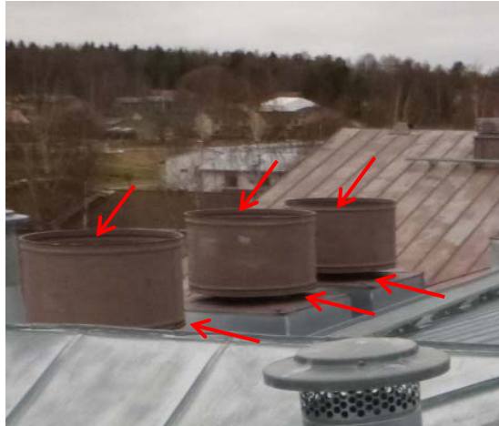
Kuva 140. Vesikatolla olevien raitisilmanottokatosten pieneläinsuojaus oli puutteellinen ennen tutkimuksia (kuvassa koneiden 301 ja 304 katokset)
