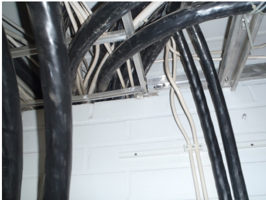
Kuva 230. Kaapelihyllyasennuksia ja läpivienti ei osastoivassa seinässä.
