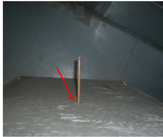
Kuva 182. Tulosuodatinkammion anturiläpiviennissä suojaamatonta mineraalivillaa
