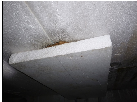
Kuva 16. Rakennusaikaisessa tulipalossa käytävällä tilan 141 kohdalla vaurioituneen lämmöneristeiden kohdalle on asennettu mineraalivillaa, mikä on kostea.
