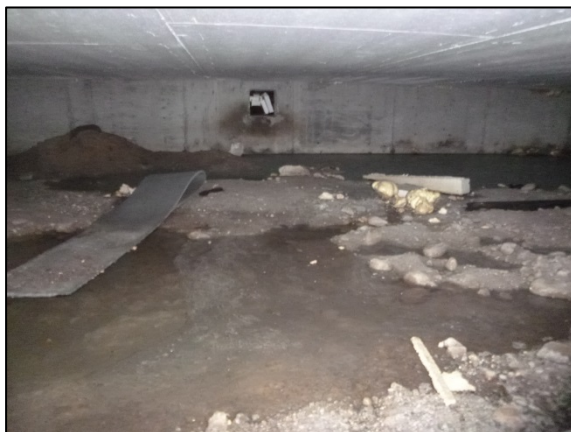
Kuva 13. Alapohjassa on veden lammikoitumista.
