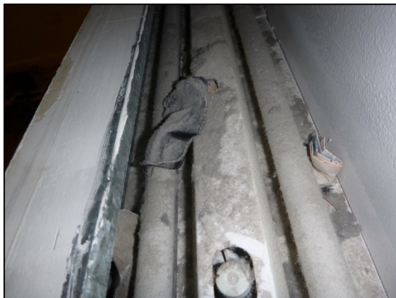
Kuva 73. Tilan 309 alakattoon tehdyn reunan päälle on kertynyt runsaasti pölyä ja muuta roskaa.
