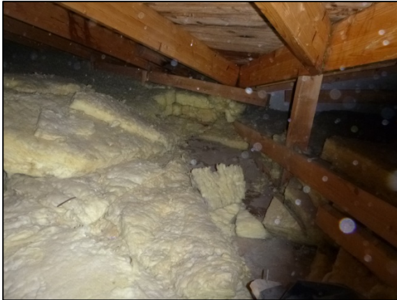
Kuva 115. Katteen vuodon kohdalta on poistettu lämmöneristeet tilan 312 yläpuolella.
