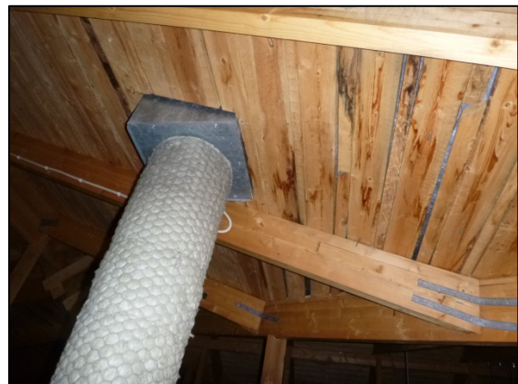
Kuva 114. Katteen läpiviennin kohdalla oleva vuoto.
