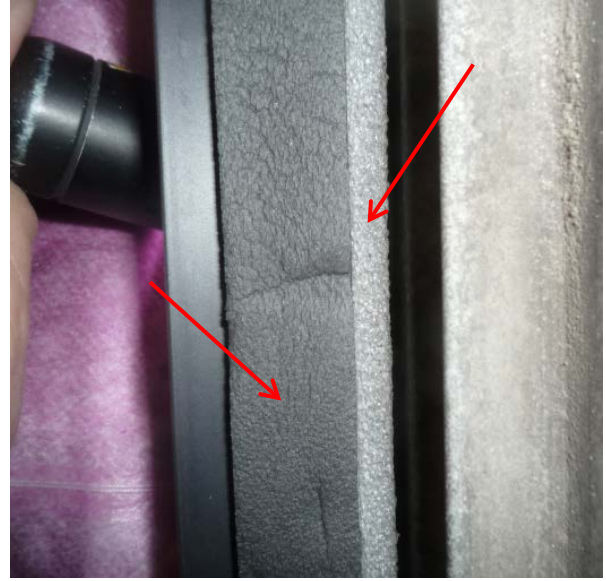
Kuva 168. IV-kone 302, tutkimusten aikana tuloilma-suodattimien tiiviyttä on parannettu lisäämällä tiivisteitä
