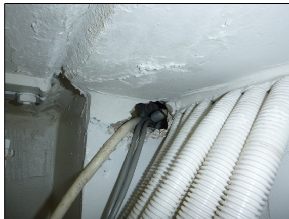
Kuva 72. Tilassa 319 olevaa sähköläpivientä ei ole tiivistetty, läpiviennissä on avointa mineraalivillaa.
