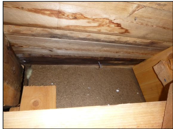
Kuva 112. Porrashuoneen kattoikkunan läpiviennin kohdalla oleva vuoto.
