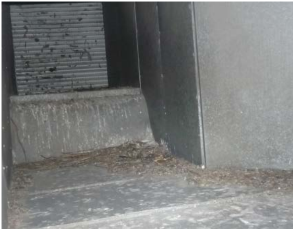
Kuva 188. IV-koneen 304 raitisilmakanavaan oli ennen tarkastusta kertynyt runsaasti orgaanista materiaalia
