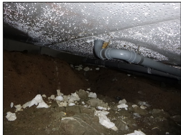
Kuva 12. Eristeen alapinnassa on tiivistynyttä kosteutta.
