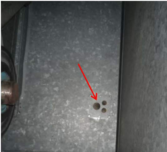
Kuva 185. IV-kone 303, tulopuhallinkammion läpivientivara- uksissa suojaamatonta mineraalivillaa
