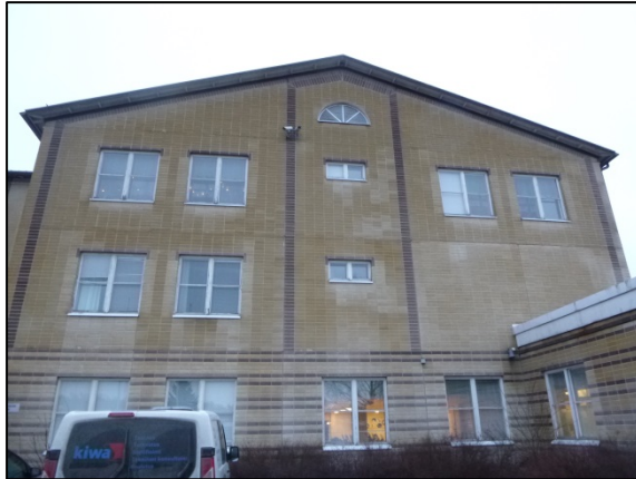
Kuva 25. Ulkoseinä rakenteen tuuletuvuus on havaintojen perusteella puutteellinen. Ainoastaan elementtien reuna-alueet tuulettuvat riittävästi.
