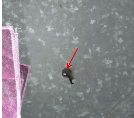
Kuva 170. Tulo-suodatinkammion anturiläpiviennissä on suo-jaamatonta mineraalivillaa
