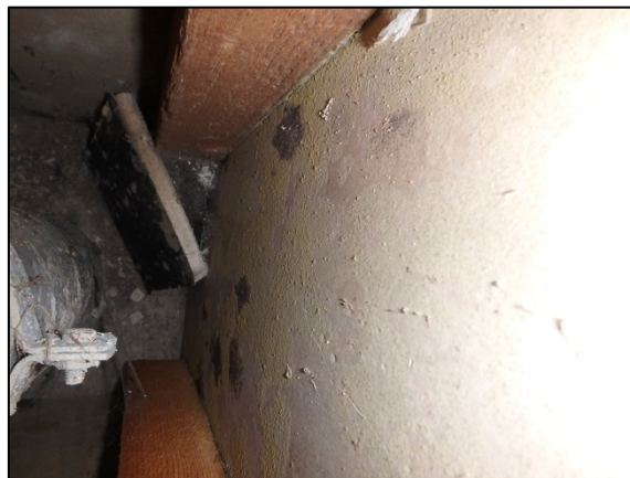
Kuva 103. Koteloinnin sisäpuolisissa osissa on havaittavissa mikrobikasvustoon viittaavia jälkiä.
