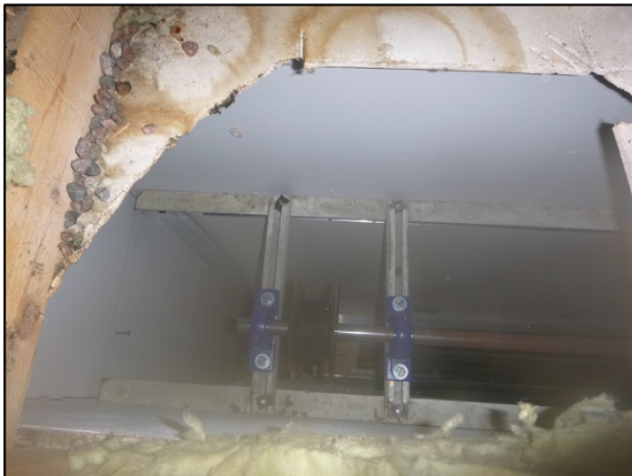
Kuva 129. Liikuntasalin jakoverhon yläpuolella on yläpohjajälään avoimia reikiä.
