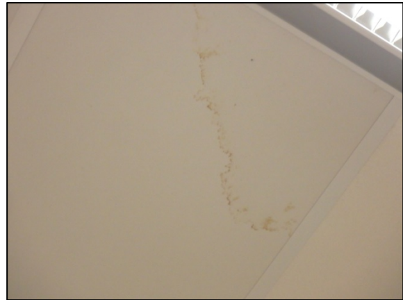
Kuva 66. Kosteusjälkiä kolmannen kerroksen akustiikkalevyissä.
