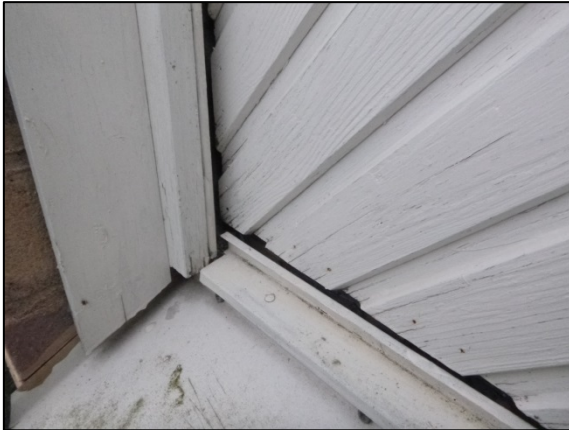
Kuva 41. Liikuntasalin ikkunat on suljettu paneloinnilla, mikä ei ole tiivis.
