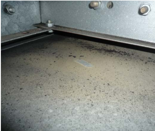
Kuva 175. IV-kone 302, tutkimusten alussa tulopuhallinkammio oli pahoin likaantunut
