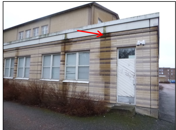
Kuva 28. Rästyspellitysten liitokset ohjaavat sadevesiä julkisivupinnalle.
