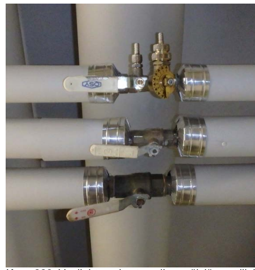
Kuva 226. Vesijohtoverkoston alkuperäisiä venttiilejä
