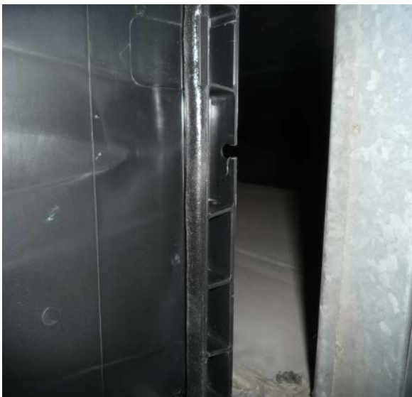
Kuva 190. IV-kone 304, kennomallisten tuloilmasuodattimien reunassa oli erittäin suuri ohivirtaukset mahdollistava rako
