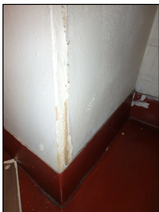
Kuva 108. Hormikoteloinnin ulkopuoliset osat ovat osin vaurioituneet kosteudesta.
