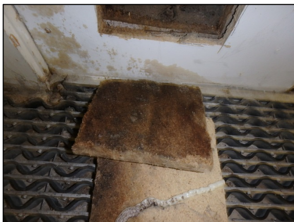
Kuva 60. Seinän ulompi lastulevy on kosteusvaurioitunut.
