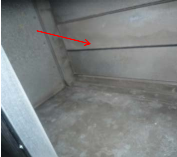
Kuva 151. IV-kone 301, raitisilmapellin toiminta korjattu (Helmi- mikuu -18)
