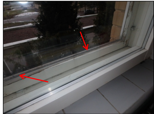
Kuva 40. Vaurioita ulkopuitteen sisäosissa.
