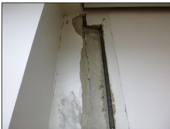
Kuva 63. Rakenneavaus toteutettiin liitoskohdalla olevan peitepellin kohdalle. Pilarin nurkassa on pitkittäinen lohkeama.
