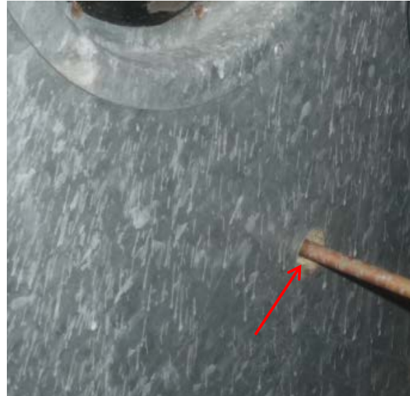
Kuva 195. IV-kone 304, anturiläpivienneissä on suojaamatonta mineraalivillaa (kuvassa LTO:n jälkeen olevan tarkastusluukun anturiläpivienti)
