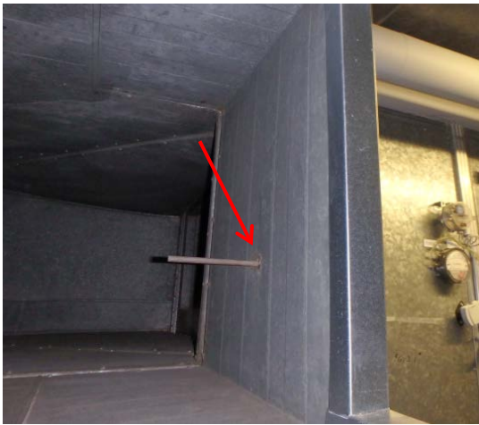
Kuva 181. Raitisilmakanavan anturiläpiviennissä suojaamatonta mineraalivillaa
