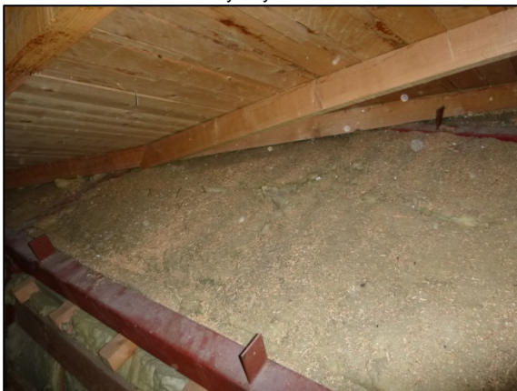
Kuva 119. Tilan 308 yläpohjassa on mahdollinen tuuletuspuute.
