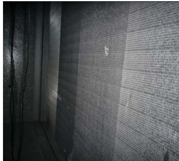
Kuva 197. IV-kone 304, lämmityspatterri on puhdistettu tutkimusten aikana
