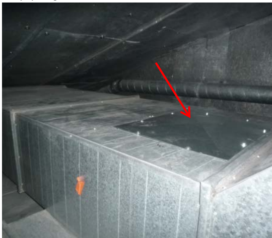
Kuva 148. IV-kone 301, raitisilmakanavan puhdistettavuus ennen tutkimuksia oli huono. Tutkimusten aikana kanavaan lisättiin puhdistusluukkuja
