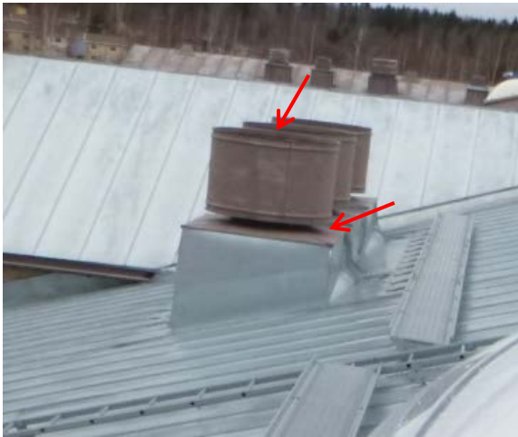
Kuva 161. Vesikatolla olevien raitisilmanottokatosten pieneläinsuojaus oli puutteellinen ennen tutkimuksia (kuvassa koneiden 302 ja 303 katokset)
