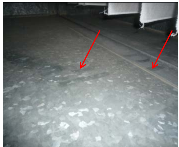
Kuva 160. IV-kone 301, poistoilmasuodatinkammiossa pölyä, kuvassa kammioon tehtyjä pyyhkäisyjälkiä
