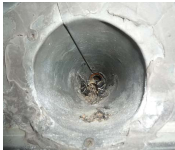
Kuva 166. IV-kone 302, raitisilmakanavan vedenpoistoputken on sisällä epämääräistä orgaanista materiaalia
