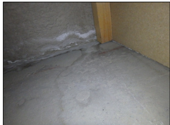
Kuva 86. Ulkoseinän ja välipohjan liitoskohta on vuotanut,
