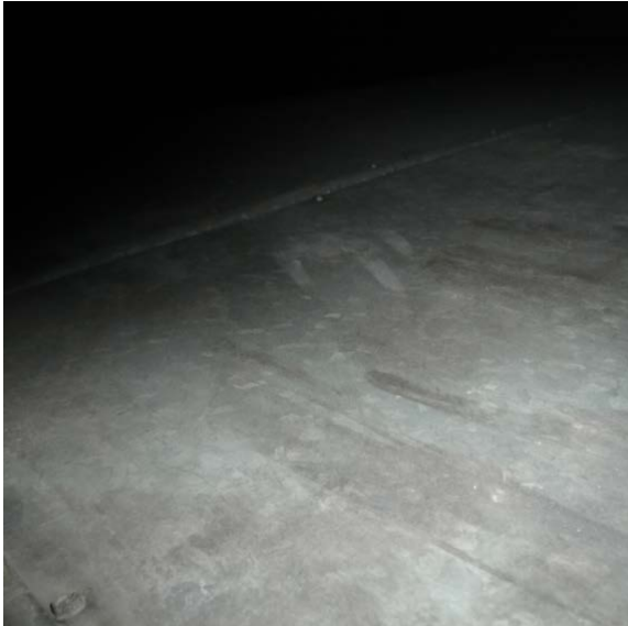
Kuva 194. IV-kone 304, tuloilmasuodattimien ohivuotojen seurauksena suodattimien jälkeinen kanavaosuus oli likaantunut (kanava puhdistettu tutkimusten aikana)
