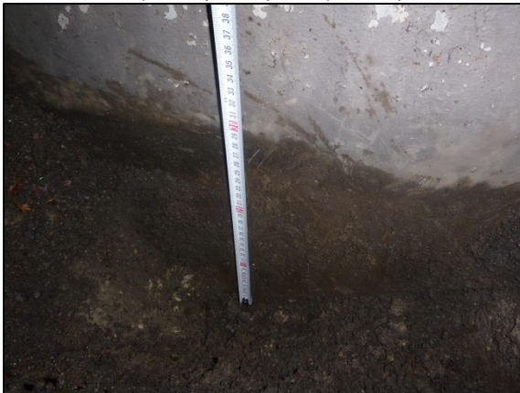
Kuva 7. Rakennuksen ympärillä ei havaittu kaikilta osin patolevytyistä, sokkelin/perusmuurin betonirakenne on kostea.
