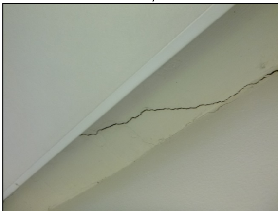
Kuva 67. Yläpohjan ontelolaattojen reuna/saumavaluissa on halkeamia.
