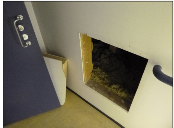
Kuva 126. Ilmanvaihtokonehuoneeseen johtavien portaiden vierellä oleva yläpohjan käyntiluukku ei ole tiivis.
