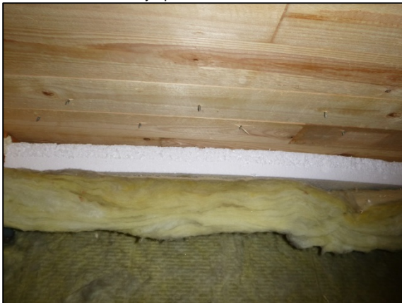
Kuva 117. Ilmanvaihtokonehuoneen kohdalla olevan yläpohjan tuuletusväli on tukossa. Solumuovi on asennettu ilmeisesti vesikatkon uusimisen yhteydessä.
