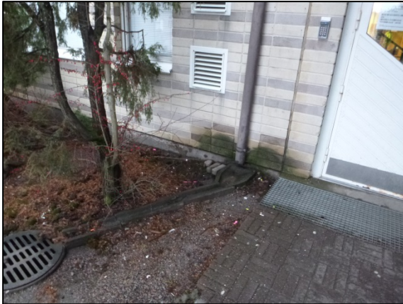
Kuva 3. Syöksytorstista tulevat vedet kastelevat sokkeli- ja ulkoseinärakennetta.
