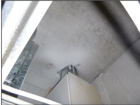
Kuva 75. Yläpohjan läpivientejä ei ole tiivistetty.
