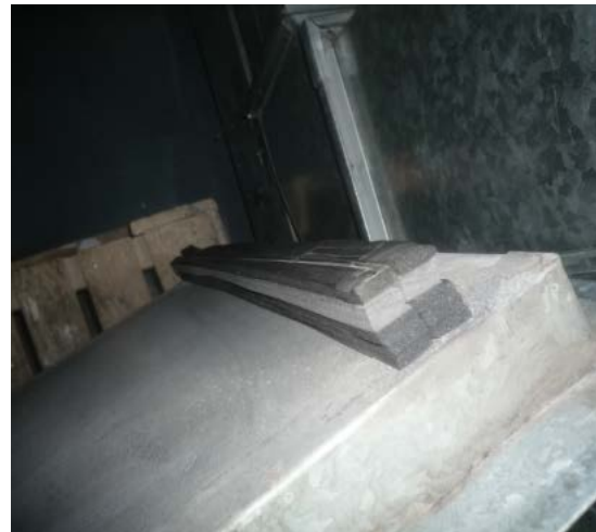
Kuva 193. IV-kone 304, tutkimusten aikana tarkastusluukkuun on lisätty ohivuodot estävä tiiviste
