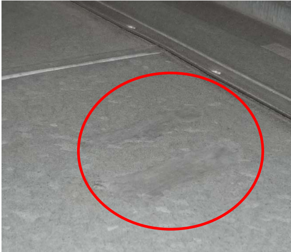
Kuva 208. Koneen 302 palvelualue, tuloilmakanava iv-konehuoneessa. Kanavassa on suodattimien ohivuoosta aiheutunutta pölykertymää
