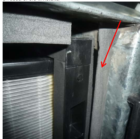
Kuva 205. IV-kone 304, suodattimien tiivistystä on parannettu ensimmäisen tarkastuksen jälkeen lisäämällä tiivisteitä, mutta tiiviyden parantaminen on edelleen suositeltavaa, kuvassa havaittavissa rako.
