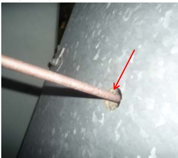
Kuva 155. LTO:a ennen olevassa anturiläpiviennissä suo- jaamatonta mineraalivillaa
