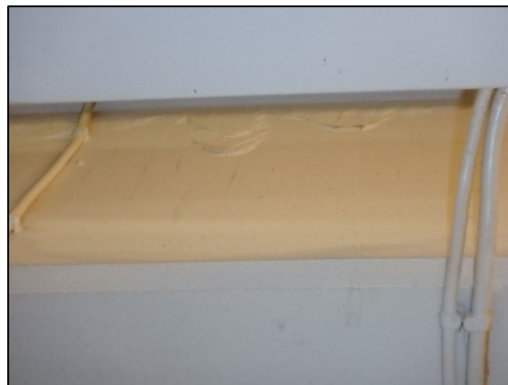
Kuva 70. Teknisen työn tilan akustiikkalevyissä ja pintarakenteissa on kosteusjälkiä ontelolaattojen sauma- ja liitoskohdissa.
