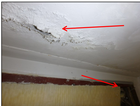
Kuva 61. Rakenneavaus toteutettiin oven yläpuoliseen ulkoseinärakenteeseen. Myös katossa on jälkiä rakenteen läpi kulkeutuneesta kosteudesta.
