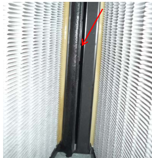
Kuva 203. IV-kone 304, poistosuodattimien kehysten välissä oli selkeä rako ensimmäisessä tarkastuksessa. Kehysten sivussa ei ole tiivisteitä
