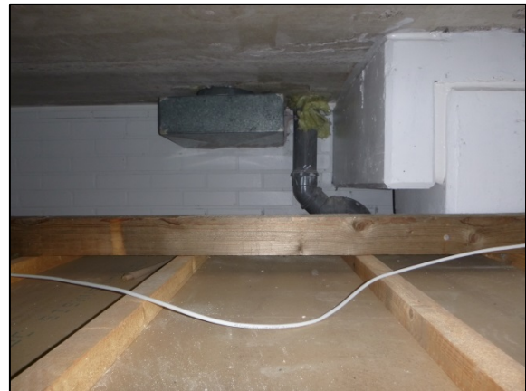
Kuva 84. Alakattorakenteessa ei ole mineraalivillaeristeitä. Välipohjan läpivienti on tiivistetty mineraalivillalla.
