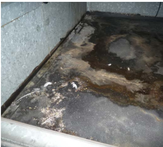
Kuva 171. IV-kone 302, LTO:n jälkeinen kammion pohja lämmityspatterin edessä oli pahoin likaantunut ennen tutkimuksia (pinttynyttä rasvalikaa)
