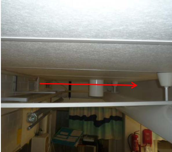
Kuva 212. Sekoittumisen kannalta huono päätelaitteiden sijoittelu luokassa 202: tuloilmavirta kohdistuu suoraan päin palkkia
