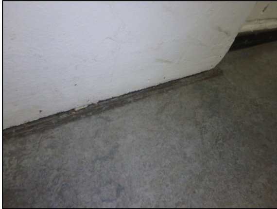
Kuva 90. Sammutinkaapin alapuolisen osan koteloinnissa on kosteusjälkiä.
