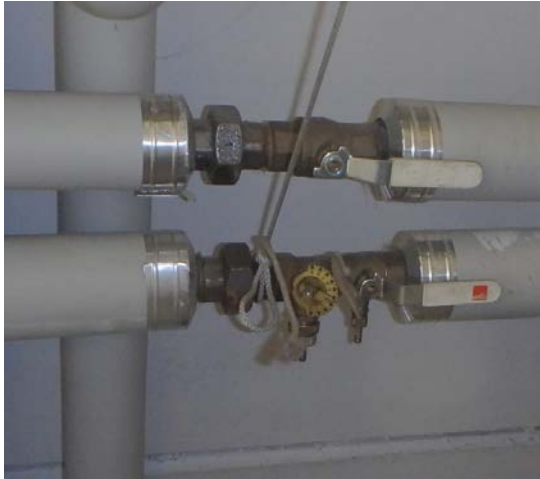
Kuva 220. Alkuperäisiä lämmitysputkia ja venttiilejä
