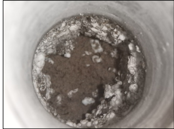
Kuva 19. Lämmöneristeinä on käytetty polystyreenieristettä. Alapohjan hiekkatäyttö on kosteata,
