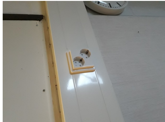
Kuva 237. Kirjastoon on lisätty muovisia johtokouruja ja näissä olevat sähkökalusteet.
