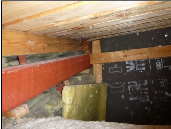
Kuva 123. Ilmanvaihtokonehuoneen päädyssä olevat eristeet on asennettu jättäen ilmvälejä eristeiden väliin. Lämmöneristeiden ja vesikatteen tuuletusväli on puutteellinen.
