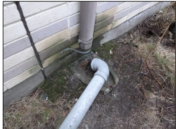
Kuva 6. Vedenohjausputki on irti syöksytorstesta.
