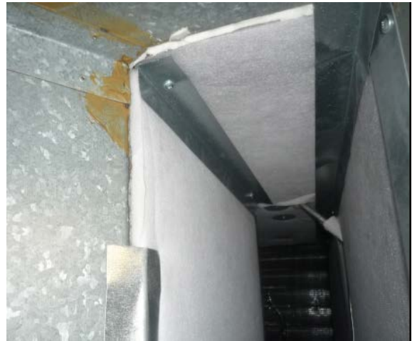
Kuva 186. IV-kone 303, äänenvaimenninosan mineraalivilla peitetty polyesteripohjaisella materiaalilla
