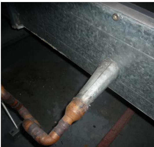
Kuva 165. IV-kone 302, raitisilmakanavan vedenpoisto on toteutettu kupariputkella, joka on hankala puhdistaa
