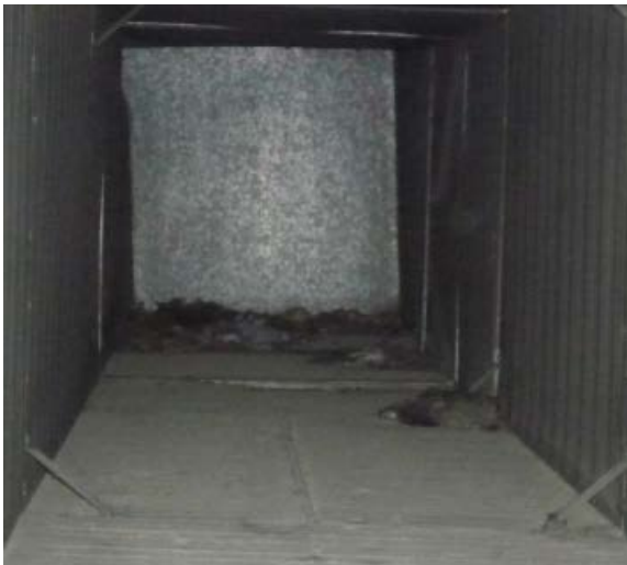
Kuva 163. IV-koneen 302 raitisilmakanava oli likaantunut ennen tutkimuksia
