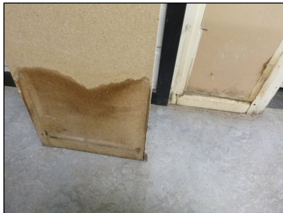
Kuva 97. Kosteus on noussut lastulevyn taustapinnalle.
