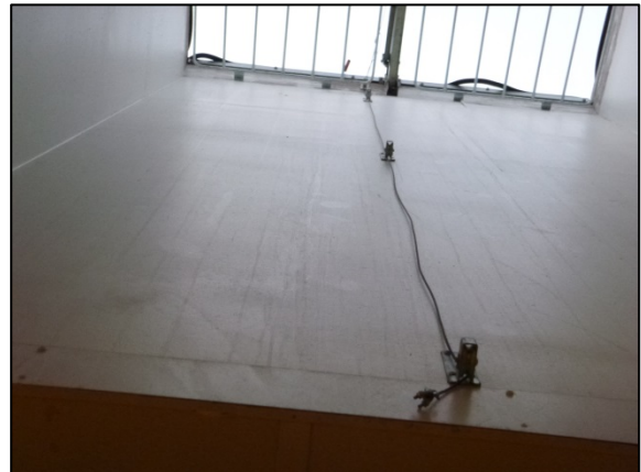
Kuva 78. Porrashuoneen valokuilun seinissä on vedenvuomajälkiä.
