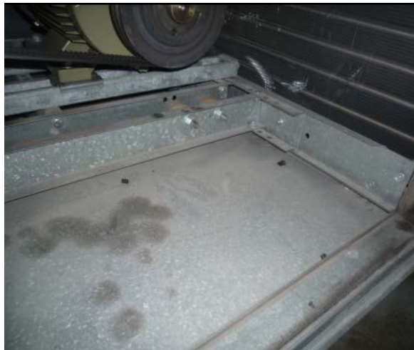
Kuva 157. Tulopuhallinkammiossa oli likaa ja hihnanpaloja 1. tarkastuksessa
