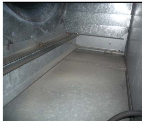
Kuva 199. IV-kone 304, tulopuhallinkammio oli likainen ensimmäisessä tarkastuksessa
