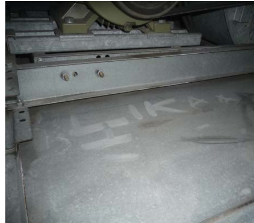
Kuva 176. IV-kone 302, tutkimusten aikana tulopuhallinkammio on puhdistettu, mutta puhdistuksen ja uuden tarkastuksen välillä pohjalle oli jo kertynyt uutta likaa
