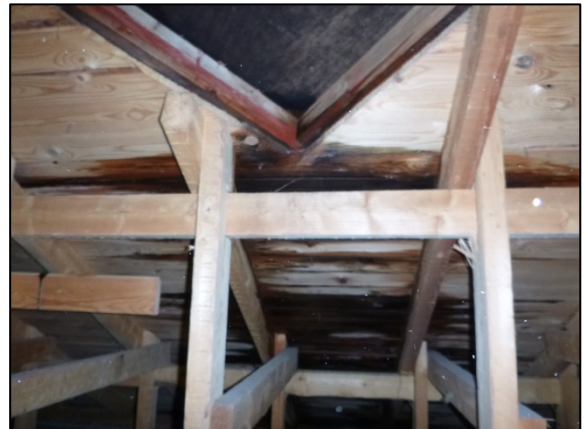
Kuva 130. Liikuntasalin yläpohjan suljetun käyttiluukun kohdalla on vesivuoto.
