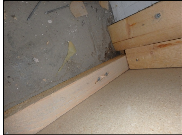
Kuva 91. Koteloinnin käytävän puoleisissa osissa on kosteuden aiheuttamia jälkiä.
