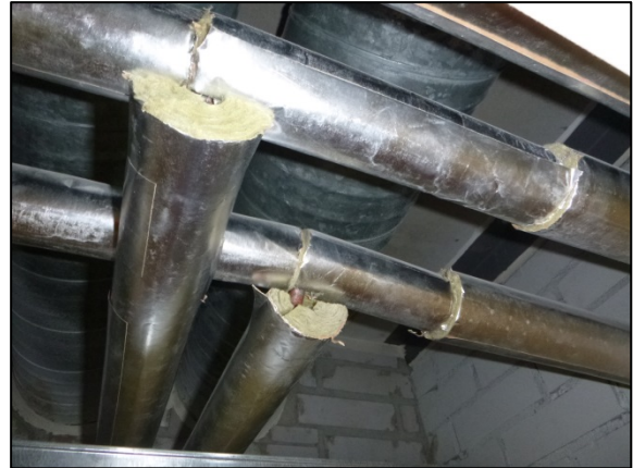
Kuva 76. Alakattojen yläpuolisissa putkieristeissä on avointa mineraalivillaa.
