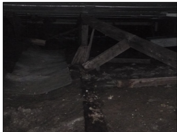
Kuva 14. Tilassa 104 olevan käyntiluukun kautta alapohjaan johtavassa tilassa on lahonnutta puutavaraa.
