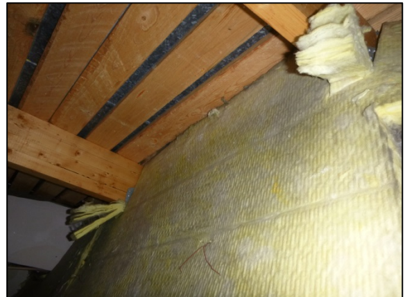
Kuva 118. Ilmanvaihtokonehuoneen yläpohjan tuuletusväli on suljettu jo rakentamisaikana.
