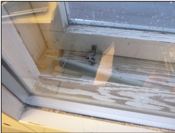
Kuva 39. Tuuletusikkunoiden aukipitolaitteet ovat paikoin rikkoutuneet ja ulkopuite pääsee aukeamaan osin tuulella.
