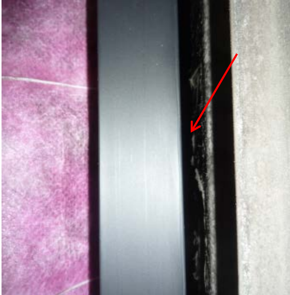
Kuva 167. IV-kone 302, tutkimusten alussa tulo-suodattimien asennus oli epätiivis
