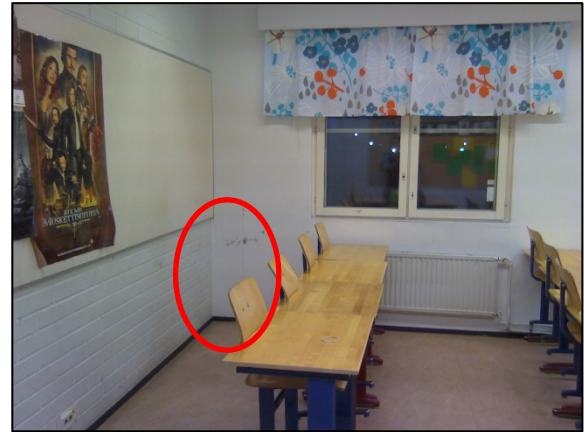
Kuva 32. Ulkoseinässä sijaitseva kylmä alue tilassa 311.
