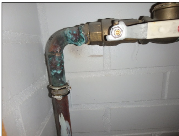
Kuva 89. Pikapalopostin vesijohdossa on ollut vuotoa.
