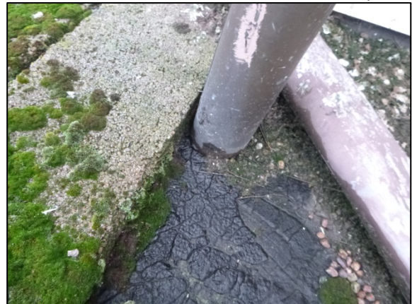
Kuva 138. Ruokalan vesikatteen pinnassa on paikoin halkeilua.
