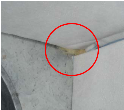
Kuva 214. Luokka 317, tuloilmapäätelaitteen vaimennusmateriaalit korvattu polyesteripohjaisella materiaalilla, mutta laatikon nurkassa on näkyvissä mineraalivillaa
