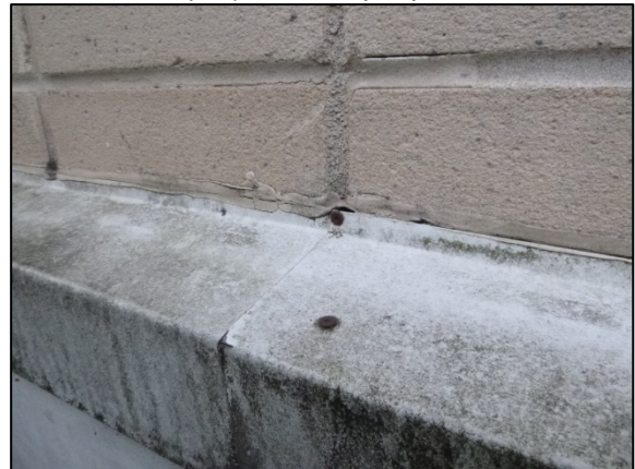
Kuva 8. Liikuntasalin portaiden kohdalla olevan suojapellityksen tiivistemassaukset ovat ikääntyneitä.
