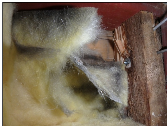
Kuva 62. Eristeen ulkopinnassa on tummentumaa. Myös puuosissa on jälkiä rakenteeseen päässeestä kosteudesta.
