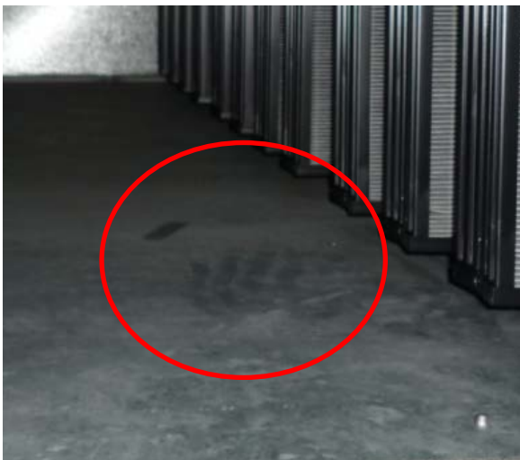
Kuva 202. IV-kone 304, kennomallisten poistoilmasuodattimien asennus ei ollut tiivis ensimmäisessä tarkastuksessa. Kuvassa pölykertymään tehtyjä pyyhkäisyjälkiä
