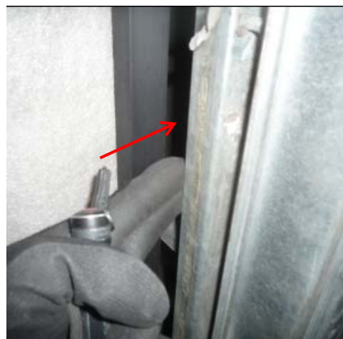
Kuva 178. IV-kone 302, poistoilmasuodattimet ovat epätiivit
