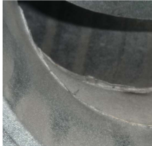
Kuva 209. Koneen 304 palvelualue, pölykertymää tuloilmakanavassa ja päätelaitteessa (luokka)
