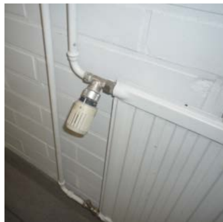
Kuva 222. Lämmityspatteri ja termostaatti keittiössä
