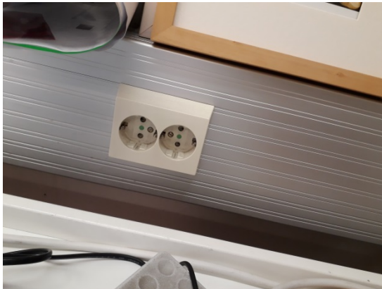
Kuva 236. Alkuperäinen johtokouruun asennettu pistorasiakaluste.
