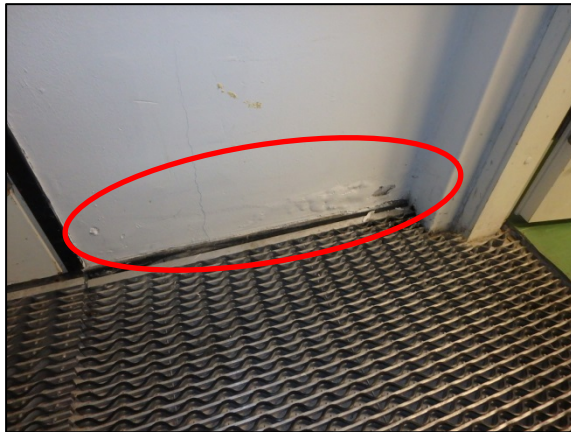
Kuva 9. Kuntosalin/liikuntasalin eteisen (tila 102) ulkoseinien alaosissa on jälkiä kosteuden pääsystä rakenteeseen.
