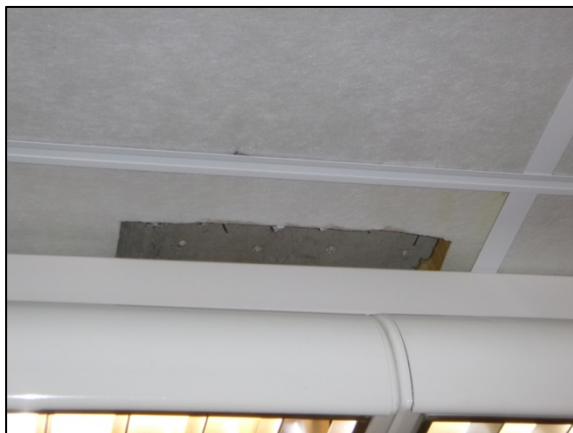
Kuva 71. Akustiikkalevyjen reunat ovat avonaisia läpivientien kohdilla.
