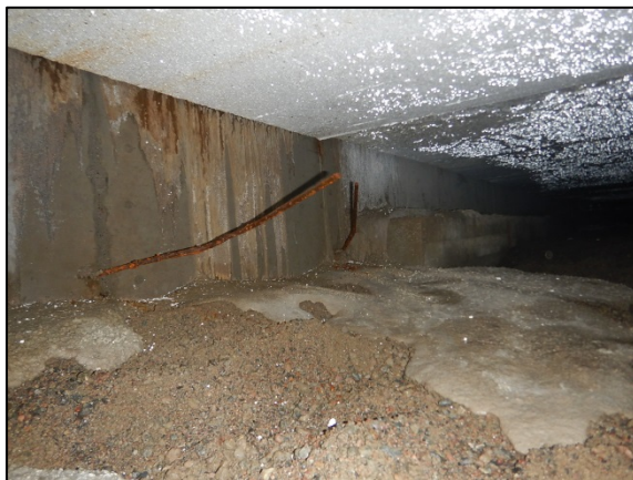
Kuva 11. Alapohjan lämmöneristeen alapinnassa on tiivistynyttä kosteutta.
