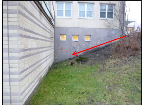
Kuva 4. Pihamaankallistukset ohjaavat sadevesiä kohti rakennusta.
