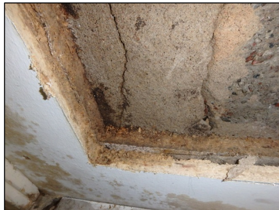
Kuva 59. Rakenteen lastulevyt ovat mikrobivaurioituneet.
