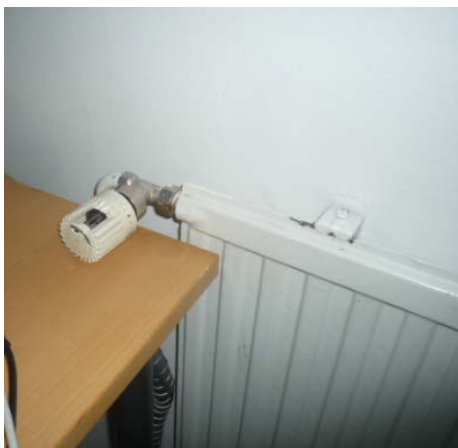
Kuva 221. Lämmityspatteri ja termostaatti luokkatilassa
