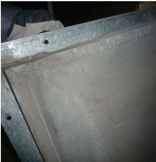
Kuva 192. IV-kone 304, tuloilmasuodattimien ohivuodoista johtuen tarkastusluukun sisäpuoli oli likaantunut
