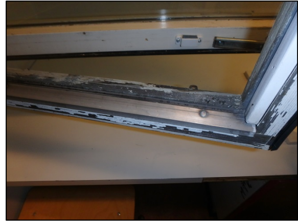
Kuva 36. Ulkopuitteen pinnoitteessa on voimakkaita vaurioita. Puuosat ovat kärsineet rakenteeseen vaurioiden takia pääsestä kosteudesta.
