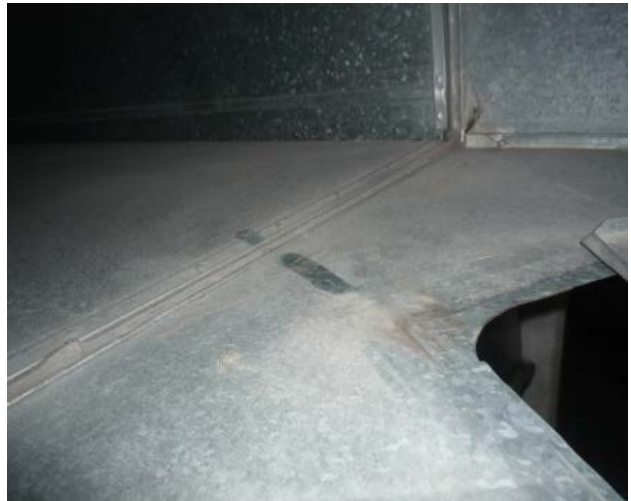
Kuva 207. IV-koneen 301 palvelualueen poistoilmakanava iv-konehuoneessa. Kanavassa normaalia pölykertymää.
