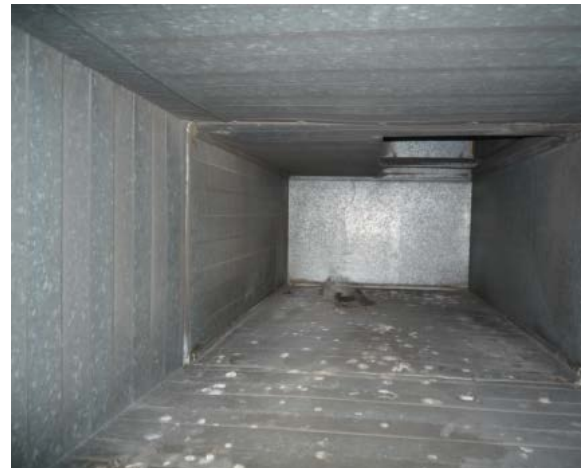
Kuva 143. IV-koneen 301 raitisilmakanava oli likaantunut
