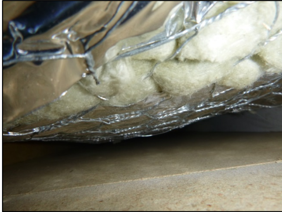
Kuva 94. Ilmanvaihtokanavan lämmöneristeet ovat osin suojaamatonta mineraalivillaa.
