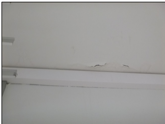
Kuva 69. Tilan 313 kattopinnoitteisiin on muodostunut kosteuden aiheuttamia vaurioita.
