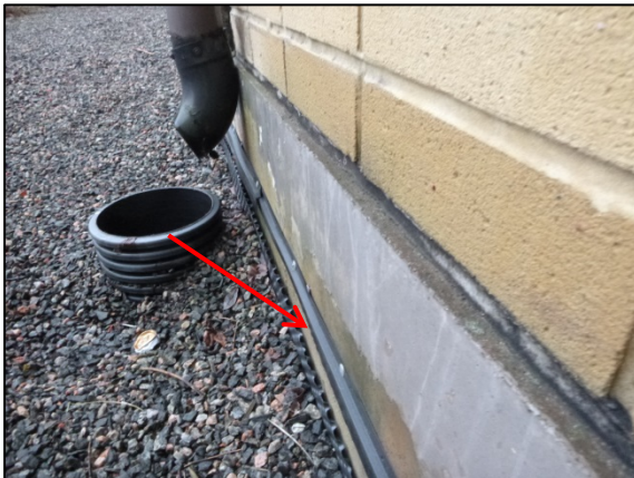
Kuva 5. Uusittu patolevy on vajonnut pois suojalistan alta.
