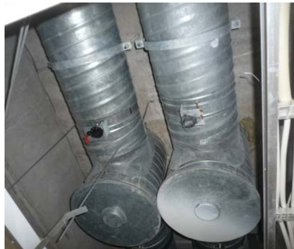
Kuva 211. Runkokanavien puhdistusluukuissa luokan 312 edustalla havaittiin lieviä vuotoja
