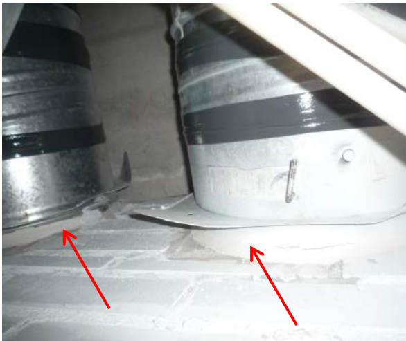
Kuva 210. Virheellisiä palopeltiasennuksia 3 krs. käytävällä luokan 342.2 edustalla. Pellit asennettu irralleen osastoivasta rakenteesta
