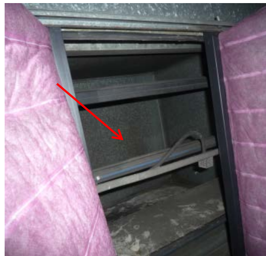
Kuva 150. IV-kone 301, raitisilmapelti ei sulkeutunut koneen pysähtyessä (Tammikuu -18)
