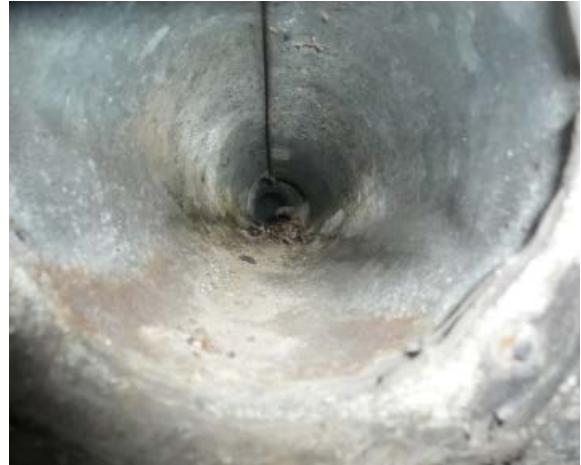
Kuva 147. IV-kone 301, ri-kanavan vedenpoistoputki osin puhdistettu tutkimusten aikana
