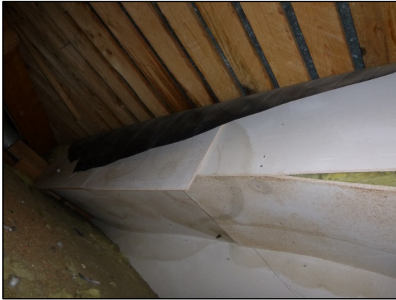
Kuva 121. Ilmanvaihtokonehuoneen päädyssä vuotojälkiä tilan 338 yläpuolella
