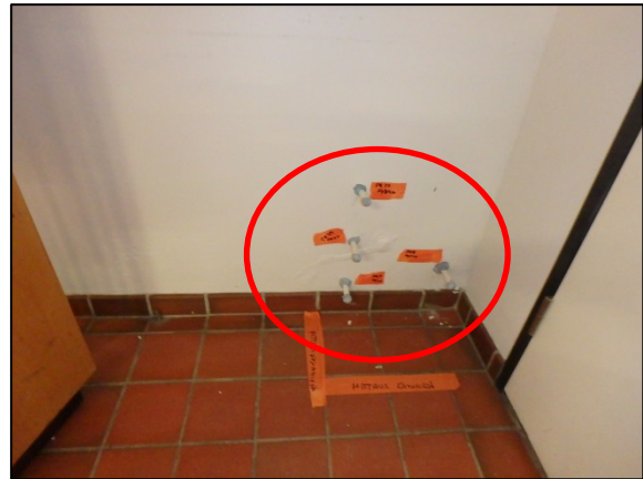
Kuva 10. Aulassa 122 on maanvastaisessa ulkoseinässä jälkiä kosteusvauriosta. Rakenteeseen toteutettiin porareikämittauksia.
