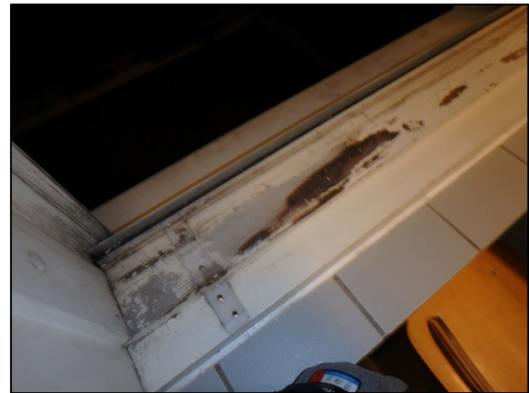
Kuva 38. Karmin alaosa on vaurioitunut ulkopuolisen kosteuden pääsystä rakenteeseen.
