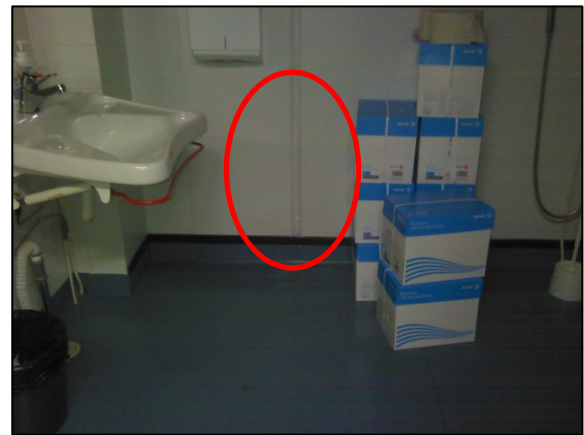
Kuva 34. Kylmä alue ulkoseinärakenteessa 2.kerroksen inva wc-tilassa
