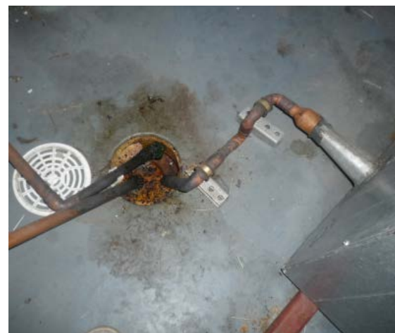
Kuva 145. Raitisilmakanavien vedenpoisto on toteutettu kupariputkilla, jotka on hankala puhdistaa. Oikealla koneen 301 ri-kanava.
