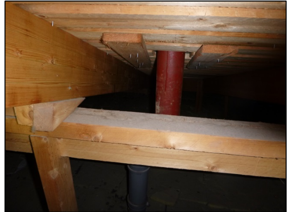
Kuva 116. Viemärin tuuletusputkia ei ole eristetty tai eristeissä on avonaisia kohtia.
