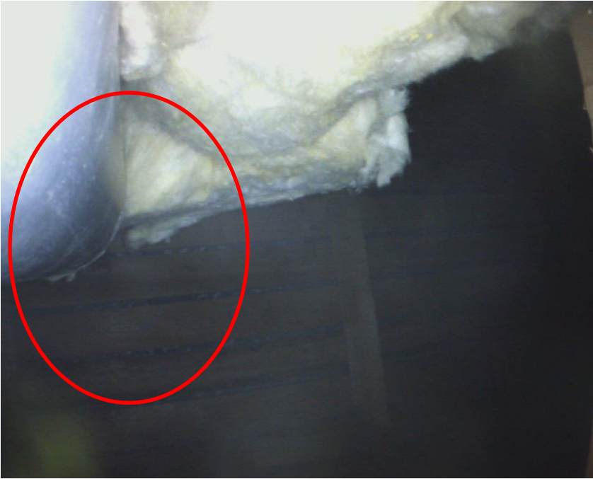
Tuuletusviemäri yläpohjassa (luokkahuone 102).
