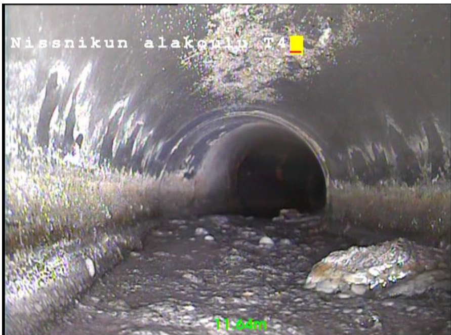
Putken pohjassa kovaa talousjätettä (T5).
