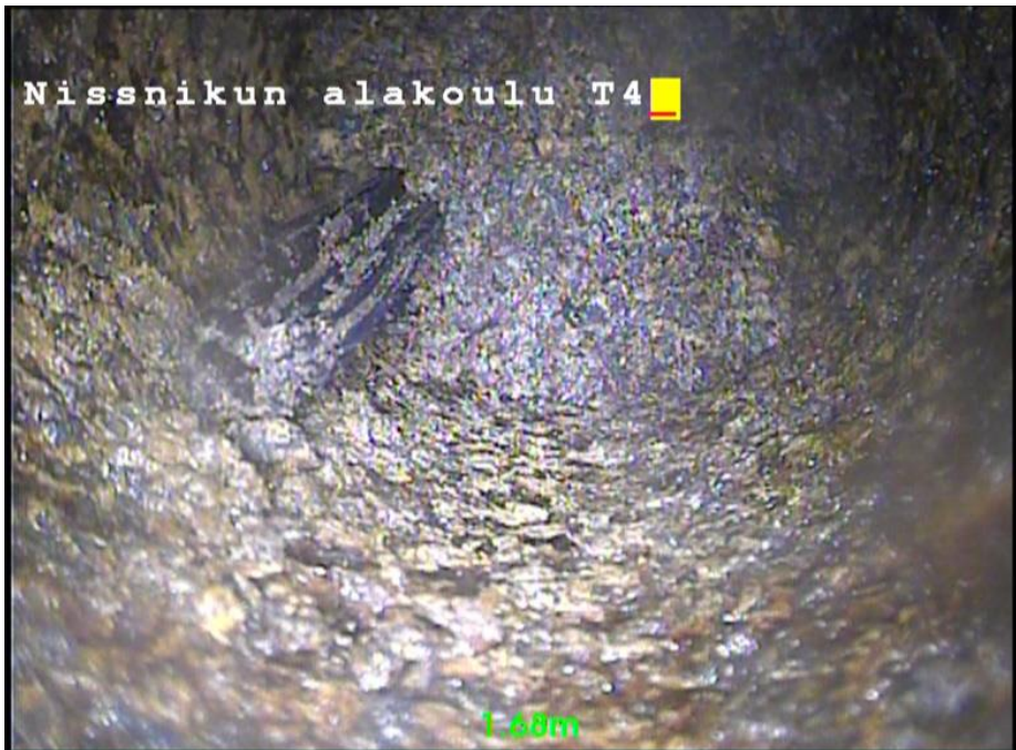
Ruostetta ja muuta jotka tukkii tuuletusviemärin (T4).
