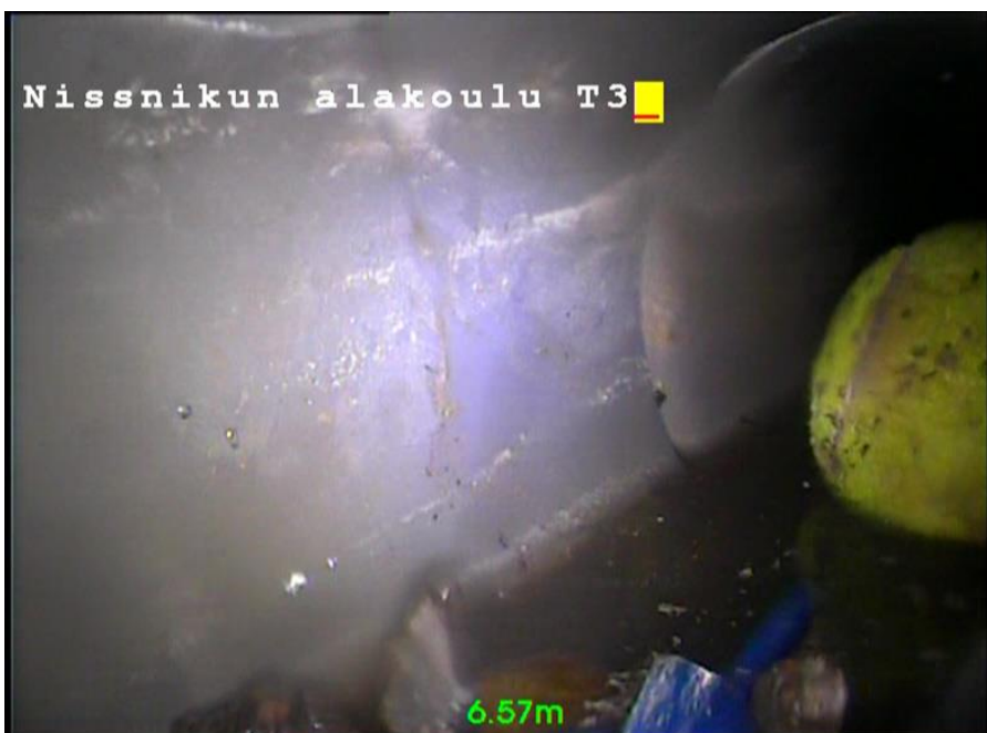
Kuulumattomia esineitä tuuletusviemärissä (T3).
