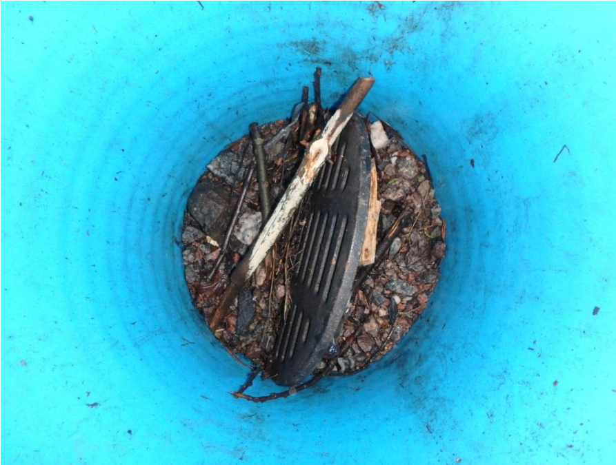
kaivo täynnä kiviä ja soraa. Kaivon kansi ei saatu irti.
