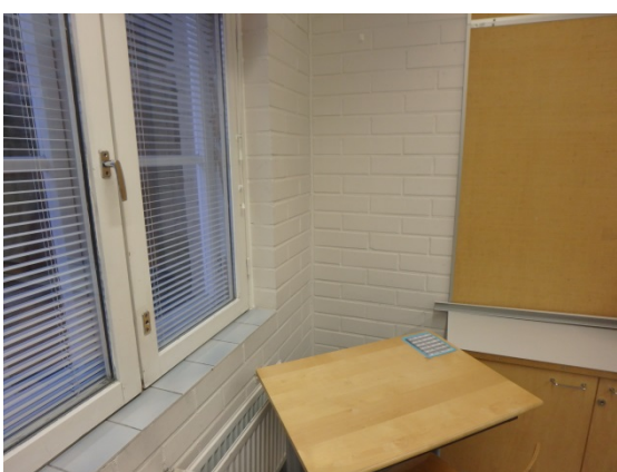
Kuva 27. Koira ilmaisi ikkunapenkin ja ikkunan liitokseen.
