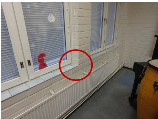
Kuva 23. Koira ilmaisi ikkunapenkin ja ikkunan liitokseen.
