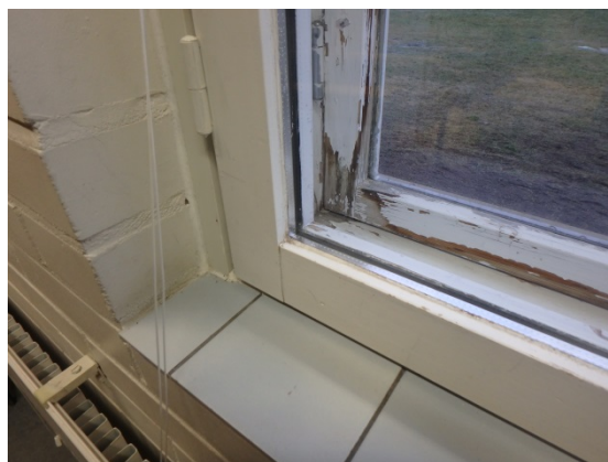
Kuva 22. Koira ilmaisi ikkunapenkin ja ikkunan liitokseen.
