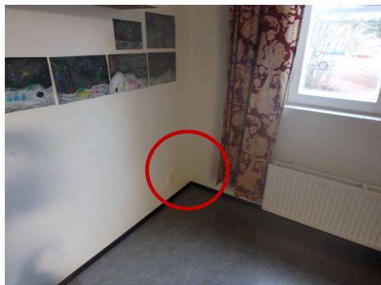
Kuva 14. Koira ilmaisi huoneen nurkkaan lattian ja seinän rajaan.
