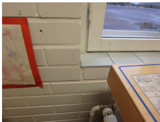
Kuva 28. Koira ilmaisi ikkunapenkin ja ikkunan liitokseen.
