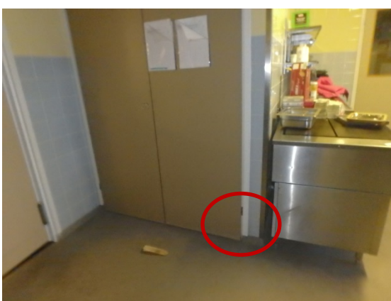
Kuva 15. Koira ilmaisi kaapin kosteusvaurioituneita oven alaosia.
