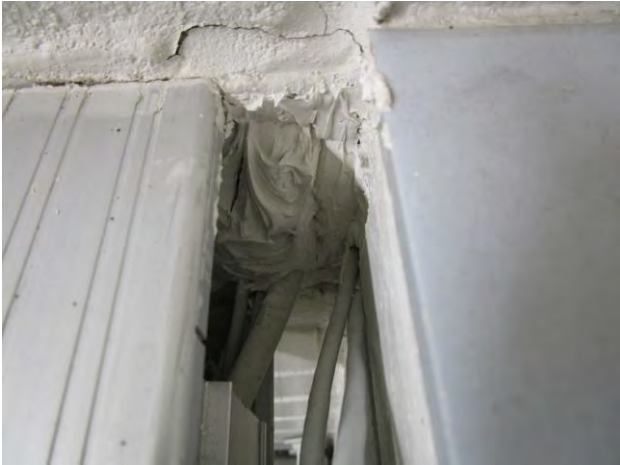
Kuvat 60-62: Vuotoilmavirtauksia väliseinään kaapeleille tehdystä ja puutteellisesti tiivistetystä läpiviennistä (24)
