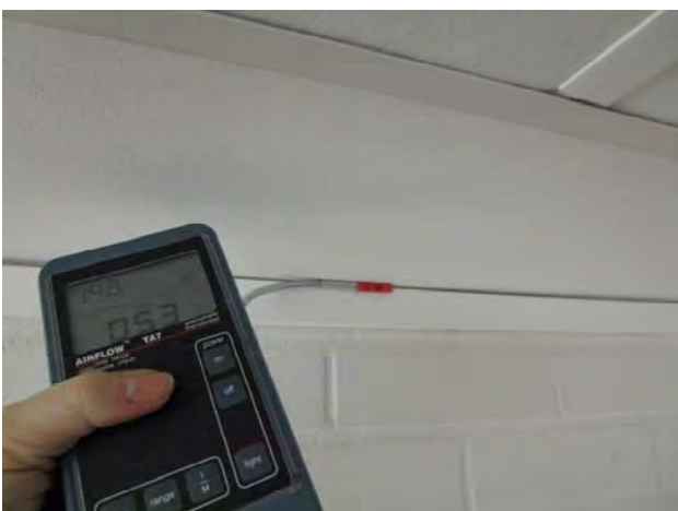
Kuvat 151-153: Vuotoilmavirtauksia ulkoseinän tiilimuurausten ja yläpohjan välisestä liitoksesta (56)
