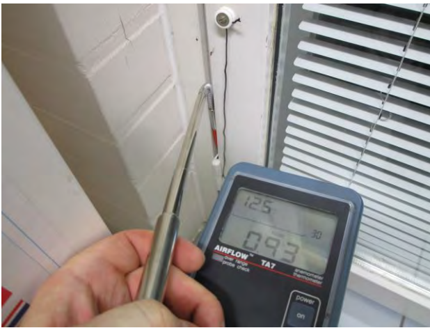
Kuvat 11-13: Vuotoilmavirtauksia ikkunan karmin ja puitteiden välistä (5)
