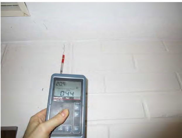
Kuvat 189-191: Vuotoilmavirtauksia betonipilarin reunassa olevasta halkeamasta (71)
