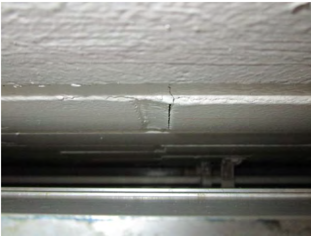
Kuvat 22-24: Vuotoilmavirtauksia ulkoseinän tiilimuurauksen pystysaumassa olevasta halkeamasta (10)
