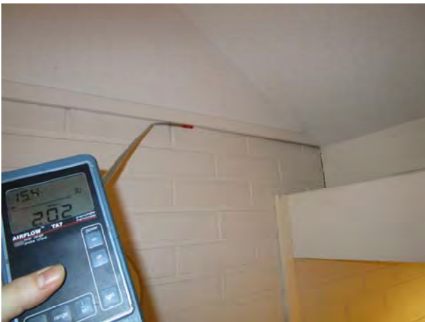
Kuvat 260-262: Vuotoilmavirtauksia tiiliseinien liitoksesta korkean tilan seinärakenteeseen (99)
