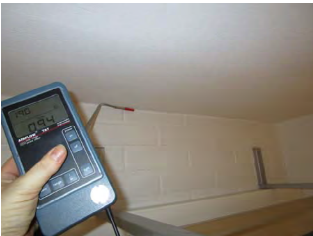
Kuvat 208-210: Vuotoilmavirtauksia ulkoseinän ja yläpohjaverhouksen välisestä liitoksesta (79)
