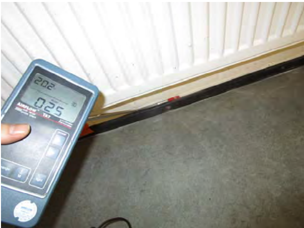
Kuvat 162-164: Pieniä vuotoilmavirtauksia ulkoseinän ja alapohjan liitoksesta jalkalistan takaa (60)
