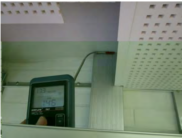
Kuvat 144-146: Vuotoilmavirtauksia sähkökotelon liitoksesta yläpohjaan (53)
