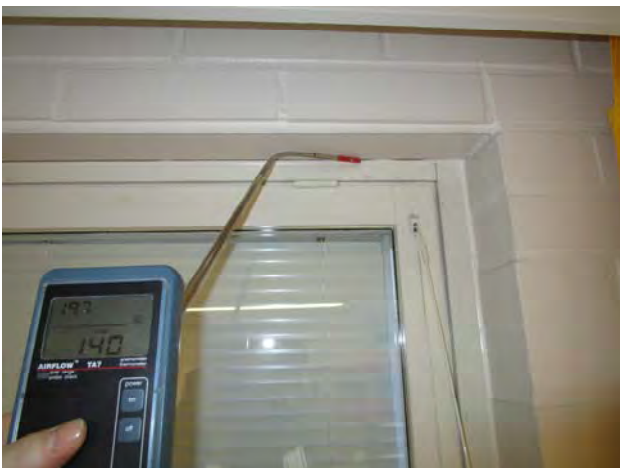
Kuvat 195-197: Vuotoilmavirtauksia ikkunan karmirakenteen ja seinän välisestä liitoksesta (73)
