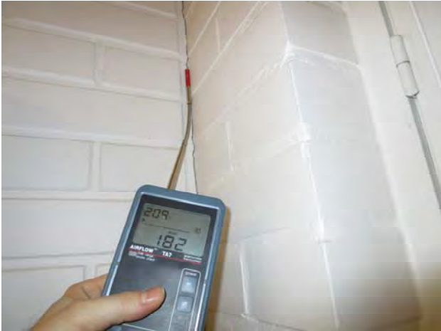
Kuvat 192-194: Vuotoilmavirtauksia väliseinän ja ulkoseinän liitoksessa olevasta pystyhalkeamasta (72)
