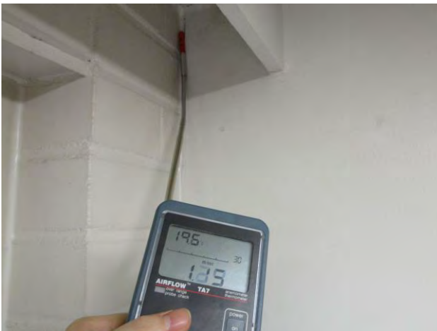
Kuvat 5-8: Vuotoilmavirtauksia ulko- ja väliseinän välisestä liitoksesta yläpohjaan (3)
