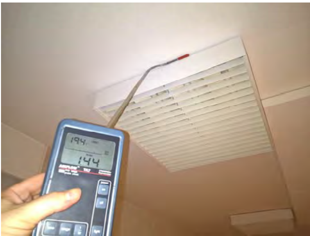
Kuvat 102-104: Vuotoilmavirtauksia yläpohjan verhouslevyn yläpuolelta (40)
