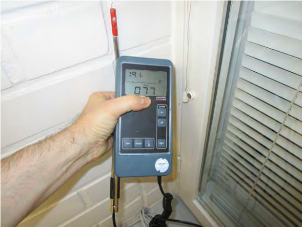
Kuvat 55-57: Vuotoilmavirtauksia ulkoseinän tiilimuurauksen ja väliseinän tiilimuurauksen välisestä halkeamasta (22)
