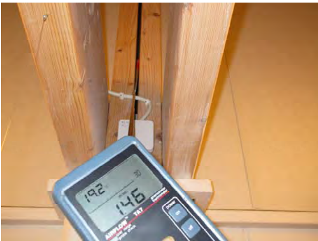
Kuvat 249-251: Vuotoilmavirtauksia korkean tilan tuplatolppien välistä (95)
