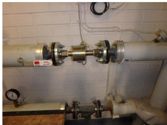
Kuva 12. Alkuperäisissä laippatiivisteissä voi olla asbestia.
