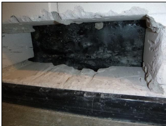
Kuva 13. Alakoulu, ulkoseinän kosteuskatko.
