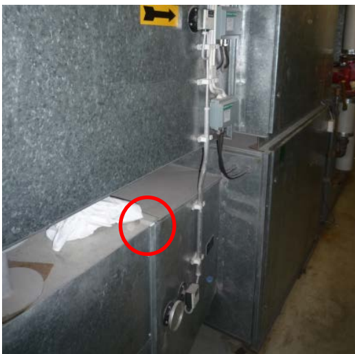
Kuva 151. TF2, äänenvaimenninosan liitos vuotaa
