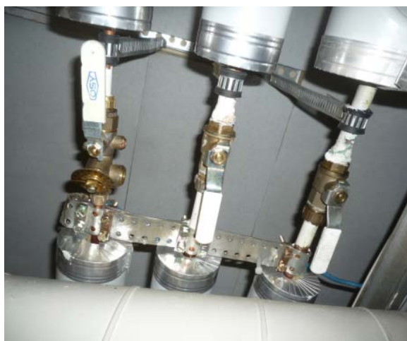
Kuva 176. Vesijohtoverkoston alkuperäisiä venttiilejä
