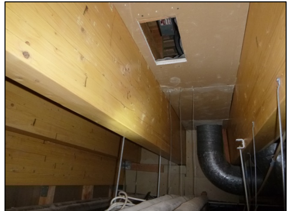
Kuva 91. Yläpohjan kipsilevyissä ja muovikalvoissa on avonaisia aukkoja ilmanvaihdon puhdistusluukkujen kohdissa. Aukoista havaittiin ilmavirtausta sisätiloihin päin.
