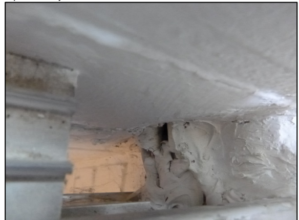
Kuva 33. Ulkoseinässä on tiivistämättömiä läpivientejä.
