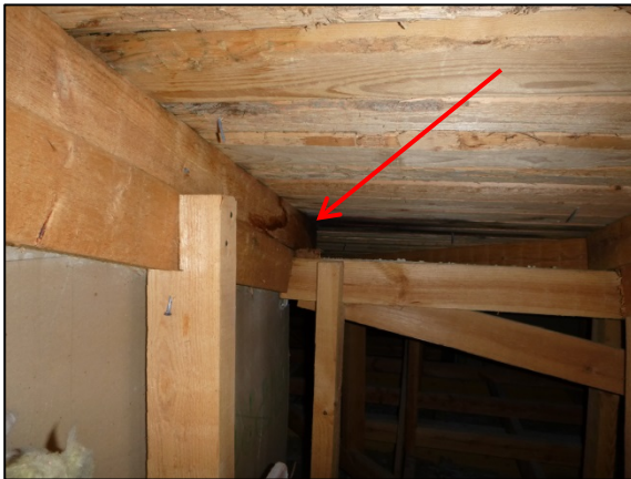
Kuva 88. Ruokalan valoikkunan nurkassa oleva vesivuoto.
