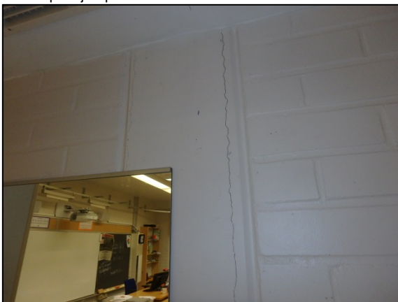
Kuva 75. Tilassa 104 olevassa betonipilarissa on halkeamia. Halkeamia havaittiin myös muutamassa muussa pilarissa.
