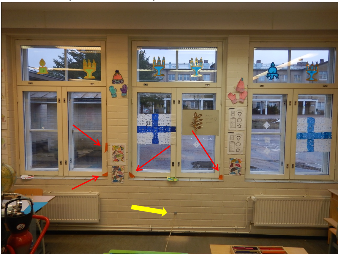
Kuva 67. Ilmavuoreittejä tilan 186 ulkoseinä rakenteessa. Merkkiaineen syöttökohta on merkitty keltaisella nuolella.
