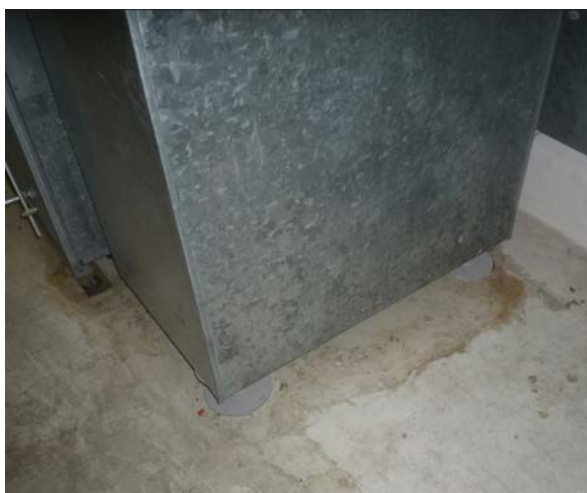
Kuva 143. TF2 raitisilmakanavan alaosan alla konehuoneen lattialla on valumajälkiä
