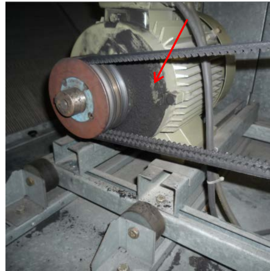
Kuva 142. PF1, poistopuhaltimen moottori on likaantunut
