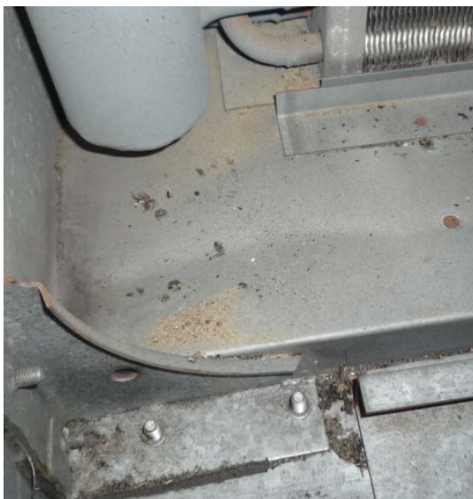
Kuva 137. TF1, puhallinkammiossa siitepölyä, hihnapuraa ja irtoroskia
