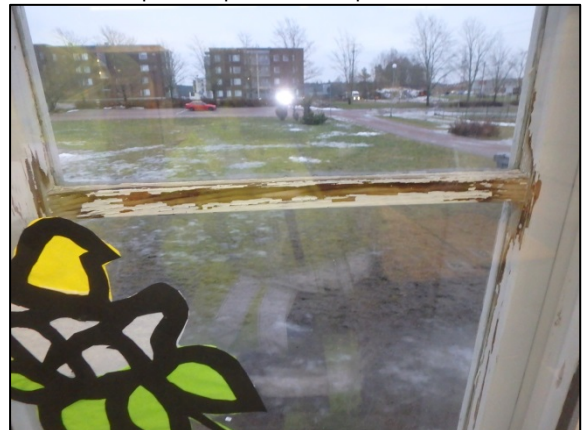
Kuva 41. Jakopuitteen maalipinnoite on kulunut.
