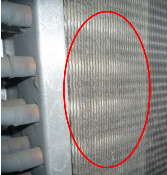
Kuva 147. TF2, lämmityspatteri on likaantunut suodattimien ohivuodon seurauksena
