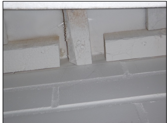
Kuva 95. Yläpohjan muovikalvon liitos ulkoseinään on avonainen.
