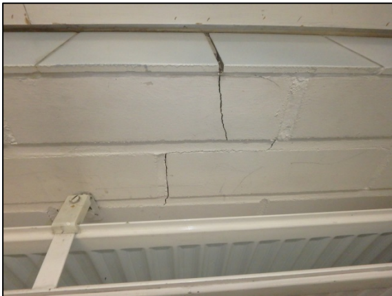
Kuva 32. Sisäkuoressa on halkeamia ikkunoiden alapuolella.
