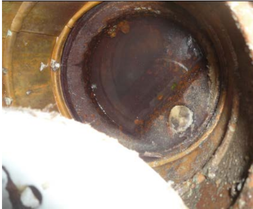
Kuva 183. Keittiön valurautainen lattiakaivo, kaivossa havaittavissa korrosiota. Korokerenkaat ovat kuparia.
