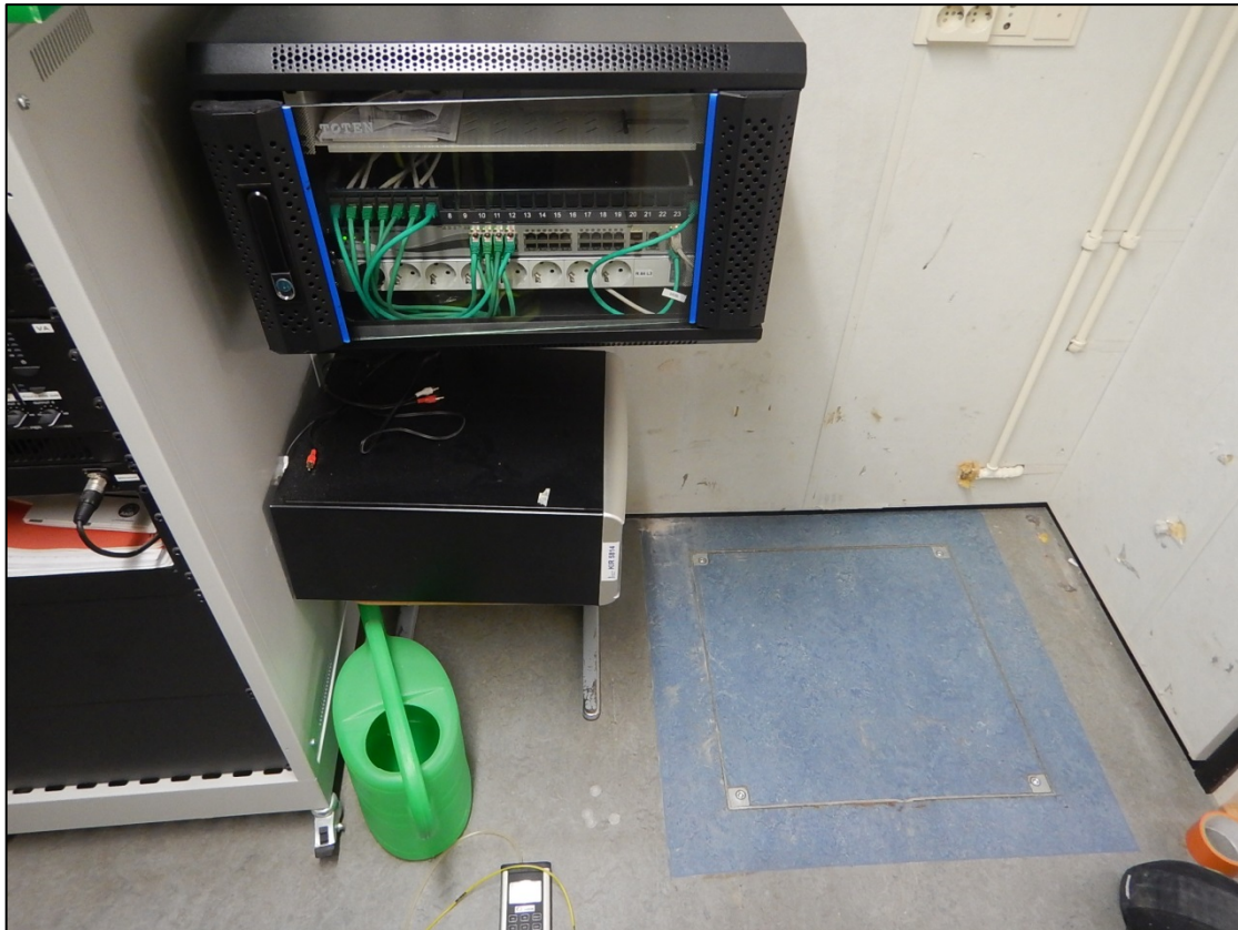
Kuva 21. Tilassa 106 ei havaittu ilmavuotoreittejä ryömintätilasta sisäilmaan.
