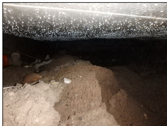
Kuva 13. Eristeen alapinnassa on tiivistynyttä kosteutta.
