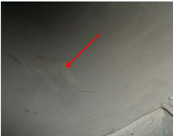
Kuva 156. Luokka 185, poistoilmakanavan pohjalle pölykertymään tehdyt pyyhkäisyjäljet. Kanavassa normaalia pölykertymää
