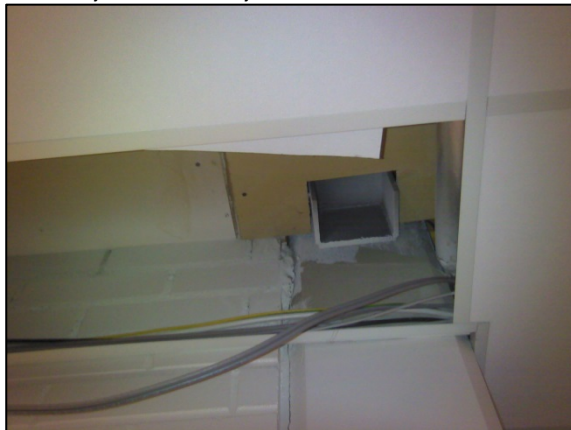
Kuva 96. Teräspilarin läheisyydessä havaittiin kylmäsilta.
