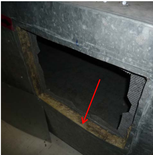
Kuva 152. IV-koneen TF1/PF1 jälkeisessä äänenvaimennustassa tuloilmakammiossa on suojaamatonta mineraalivillaa reikäpellin takana
