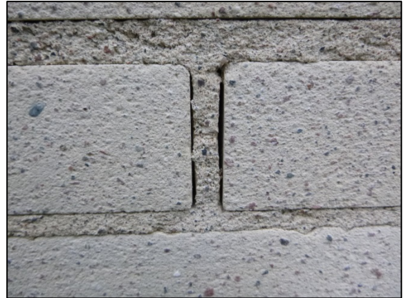
Kuva 29. Tiilimuurauksessa on auenneita saumoja ja halkeamia.
