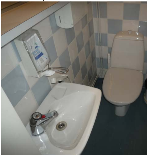
Kuva 181. Alkuperäisiä vesi- ja viemärikalusteita
