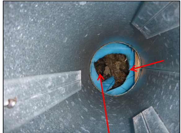
Kuva 107. Yläpohjatilan tuuletusputki uusitulla peltikate-osuudella. Pohjalla on havaittavissa kuolleita lintuja. Aluskatetta ei ole nostettu tuuletusputken kohdalla ylös.
