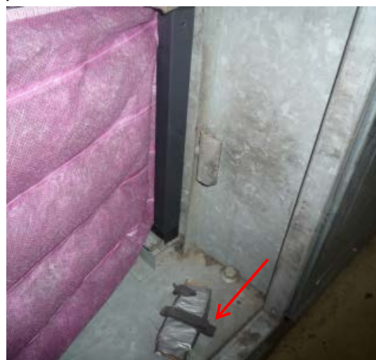
Kuva 146. TF2, tulosuodattimien asennuksessa hyödynnetty pahvinpala on tippunut paikoiltaan
