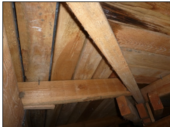
Kuva 113. Rakenneavauskohdalla havaittiin vesikatteen vuotamisesta aiheutunut märkä kohta vesikatteen aluslaudoituksessa.
