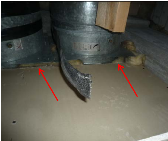
Kuva 158. Virheellisiä palopeltiasennuksia opetusväline-tilan 173 alakatossa. Pellit asennettu irralleen osastoivasta rakenteesta
