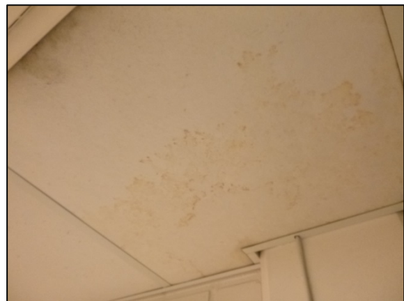
Kuva 69. Tilassa 158 on vuotojälkiä alaslaskussa.
