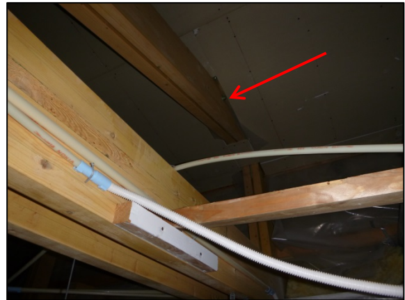
Kuva 93. Yläpohjan muovikalvoa ei ole liitetty tiiviisti rakenteisiin.
