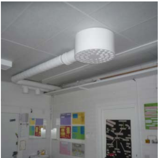
Kuva 166. Uusittu pyörrevirtamallinen tuloilmapäätelaite entisissä teknisen työ tiloissa
