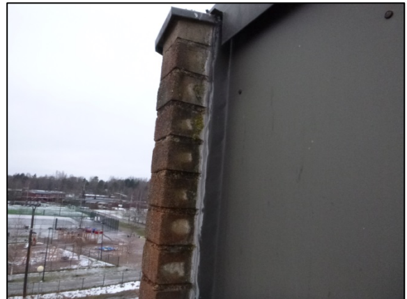
Kuva 31. Liikuntasalin yläosan julkisivumuuraus on osin rapautunut ja kostea.
