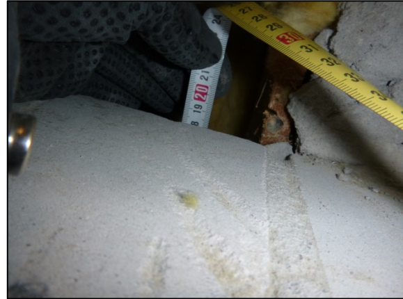
Kuva 61. Eristeen alapinta on lattiapintaa alempana.
