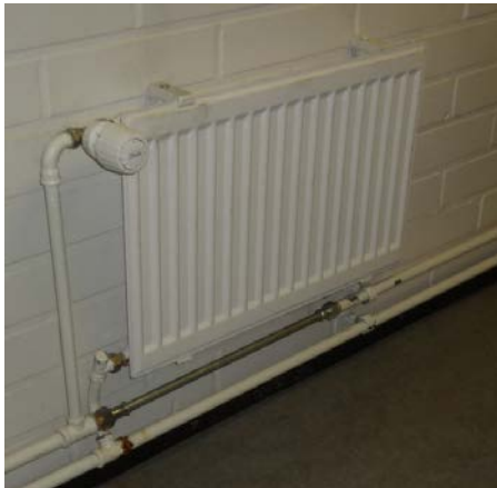
Kuva 171. Lämmityspatteri ja termostaatti. Venttiili ja termostaatti uusittu (patterin alla uusi lämpöjohto-osuus)
