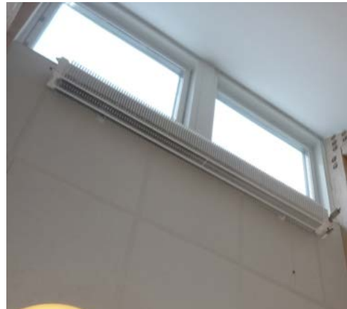
Kuva 172. Konvektorimallinen lämmityspatteri yläikkunalla. Termostaattiosa ja venttiili alkuperäisiä
