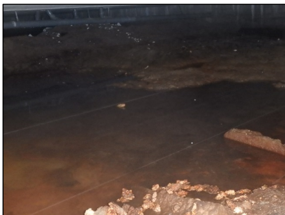
Kuva 12. Alapohjatilassa on veden lammikoitumista.
