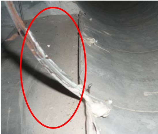
Kuva 164. Tila 174, tuloilmasäleikön takana säleikön kiinnityslaatikon pohjalla on likaa
