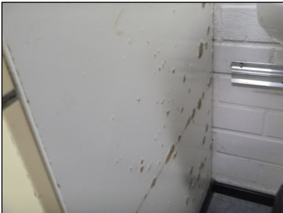
Kuva 73. Luokkatiloissa olevien käsienvesualtaiden vieresten kaapistojen pinnoissa on kosteuden aiheuttamia vaurioita.
