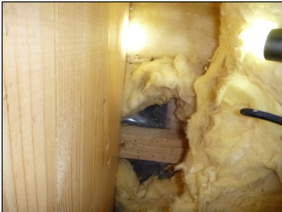
Kuva 90. Tilan 105 yläpuolisessa yläpohjassa ei havaittu vaurioitumista vesikatolla olevan luukun kohdalla. Lämmöneristeen paksuus on noin 300 mm
