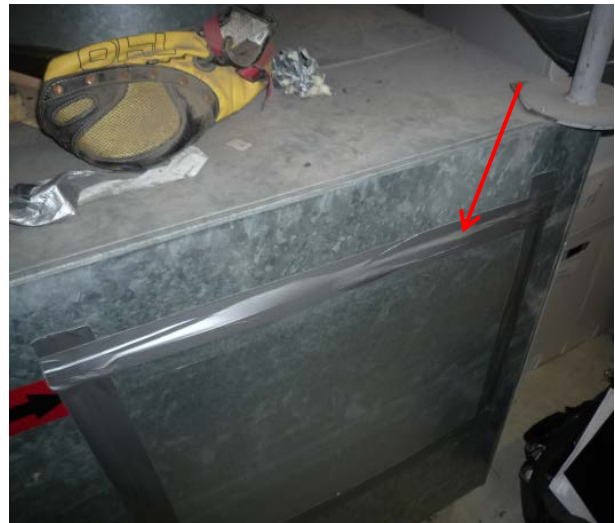
Kuva 153. IV-koneen TF1/PF1 jälkeisen tuloilmakammion puhdistusluukku vuotaa (luukku yritetty tiivistää ilmastointiteipillä)
