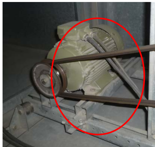
Poistoilmapuhaltimen moottori ja puhallinkammio on pölyntynyt (poistoilmassa ei suodattimia)
