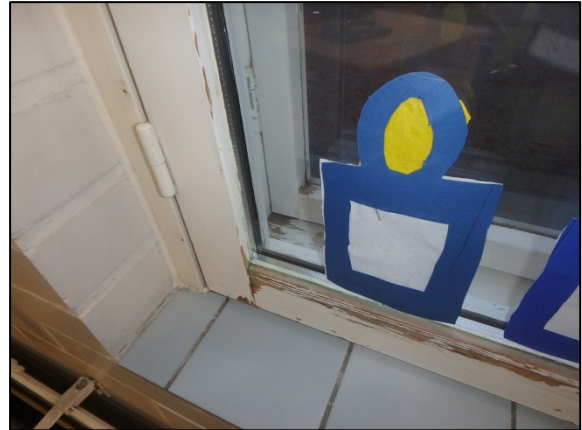
Kuva 39. Sisäpuiteen puuosissa on pinnoitteen vaurioita.
