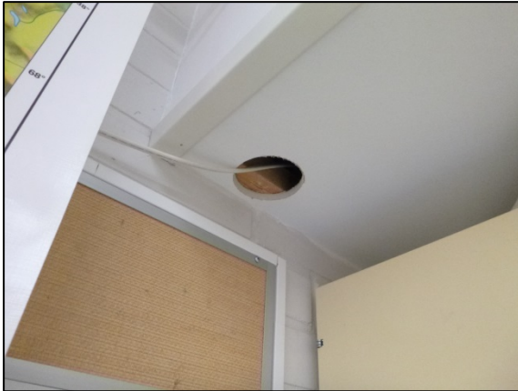
Kuva 72. Yläpohjassa olevista alaslaskujen koteloineista havaittiin ilmavirtauksia sisätiloihin päin.
