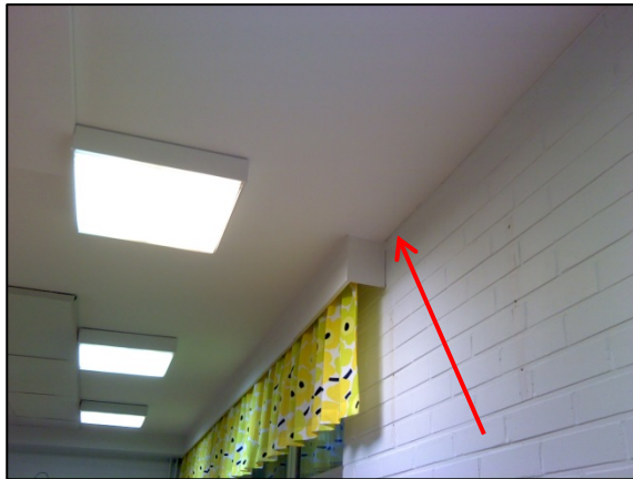
Kuva 98. Yläpohjarakenteessa kylmiä alueita sekä mahdollinen kylmäsilta.
