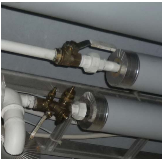
Kuva 169. Alkuperäisiä lämmitysputkia ja venttiilejä
