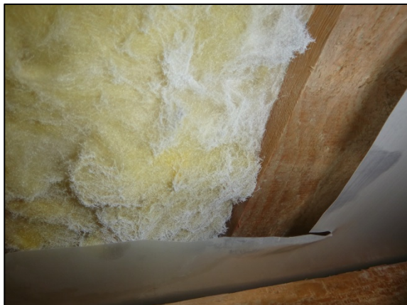
Kuva 112. Yläpohjavilloissa on seinien maalaustyön jättämiä jälkiä, eristeissä ei havaittu vaurioitumista.
