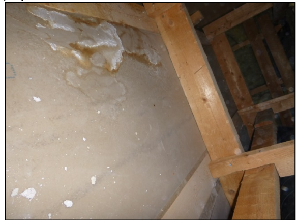
Kuva 89. Ruokalan käytävällä olevassa alakattotilassa on vanhoja vuotojälkiä. Yläpohjan muovikalvon ja lämmöneristeen välissä on noin 500 mm väli, jossa on ilmanvaihtokanavia.
