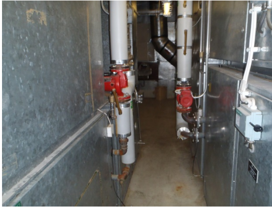
Kuva 191. IV-koneiden sähköistyksiä on uusittu tarpeen mukaan.
