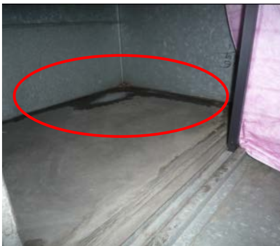
Kuva 131. Raitisilmakanavassa ennen suodatinsaa on lunta
