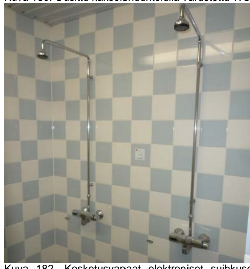
Kuva 182. Kosketusvapaaat elektroniset suihkusekoittajat suihkutilassa 109
