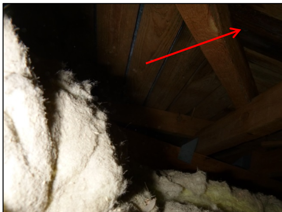
Kuva 116. Rakenneavauskohdalla havaittiin vesikatteen vuotamisesta aiheutunut märkä kohta vesikatteen aluslaudoituksessa.
