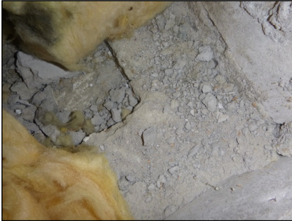
Kuva 60. Ulkoseinän alaosassa ei ole suunnitelmien mukaista bitumikermiä.
