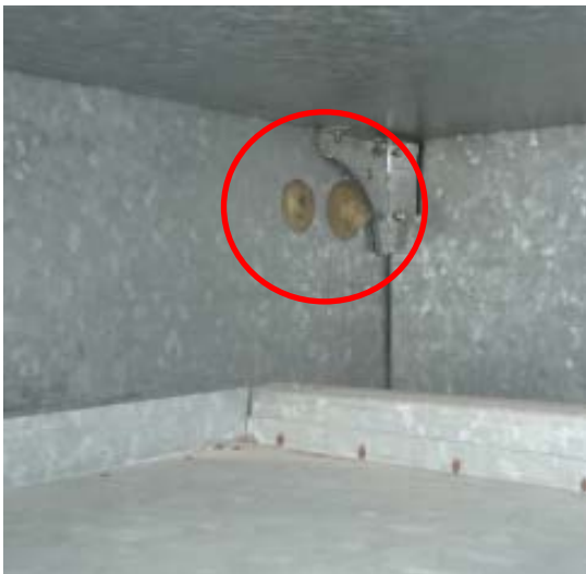
Kuva 149. TF2, tuloilmapuhallinkammiossa on suojaamatonta mineraalivillaa kaapeliläpivientivarauksissa
