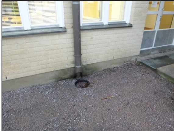
Kuva 4. Syöksytorvista tulevat vedet kastelevat sokkelirakennetta.
