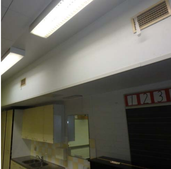
Kuva 162. Luokkatilojen päätelaitteiden sijoittelu: Tuloilmasäleiköt on asennettu kotelon otsapintaan ja poistosäleikkö on kotelon alapinnassa.
