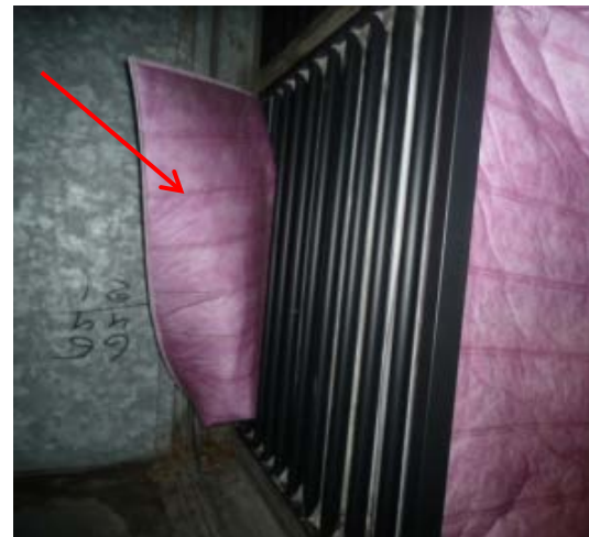
Kuva 134. Tuloilmasuodattimen suodatinpussi on käännetty kehiksen ympäri raitisilmakanavaan päin (pyrity tiivistämään kehiksen reuna?)
