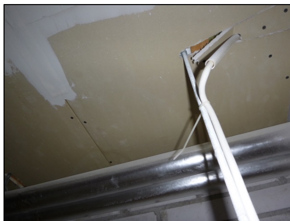
Kuva 82. Yläpohjan läpivientejä ei ole tiivistetty.
