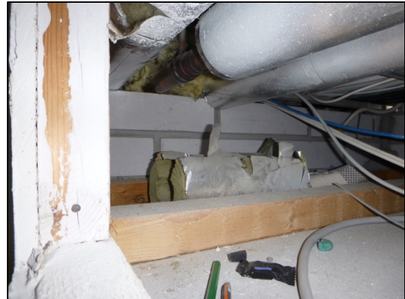
Kuva 84. Lämpöjohtojen mienraalivillaeristeet ovat osin avonaisia.
