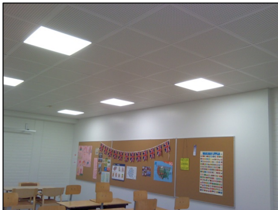
Kuva 102. Luokan ulkoseinän ja yläpohjan liitoskohdassa on ilmavuotoa.
