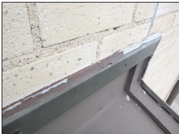
Kuva 110. Vesikaton ylönstoppellin liitoskohdalla seinään olevat vanhat tiivistemassaukset ovat ikääntyneitä. Vanhoja massauksia ei ole poistettu uusien massausten alapuolelta ja uudet massaukset ovat irronneet.
