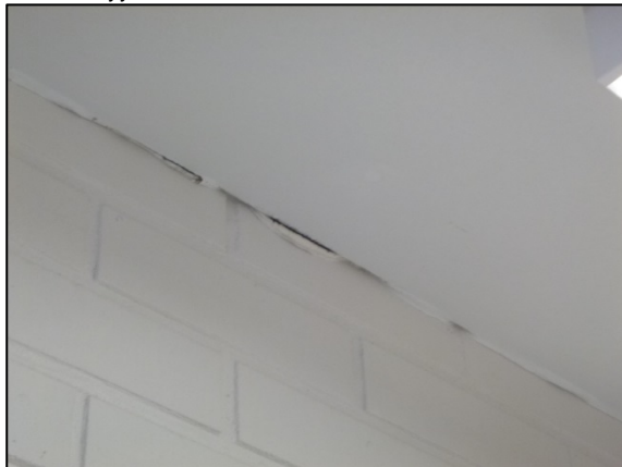
Kuva 94. Yläpohjan levytysten ja seinien liitoskohdissa on ilmavuotojen aiheuttamia jälkiä.
