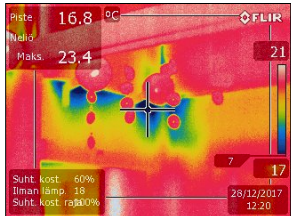
Kuva 35. Tiilimuurauksen ja ylemmän puurakenteisen ulkoseinän liitoskohdassa on lämpökuvauksen perusteella ilmapuotoa.
