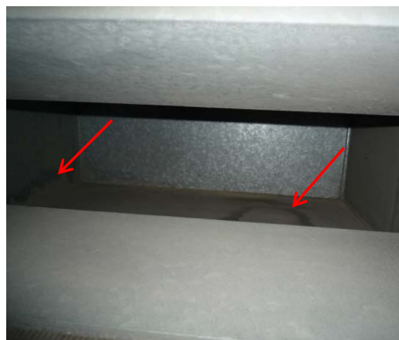
Kuva 144. Raitisilmakanavan alaosan sisäpuolella on kosteusjälkiä.
