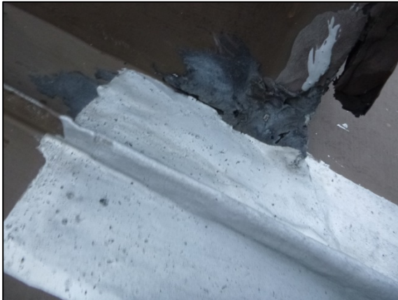
Kuva 106. Ruokalan kohdalla olevan valoikkunaseinän massaukset ovat kuluneet. Alapuoliset puurakenteet ovat märkiä.
