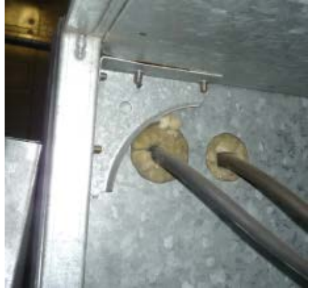
Kuva 148. TF2, tuloilmapuhallinkammiossa on suojaamatonta mineraalivillaa kaapeliläpiviennissä
