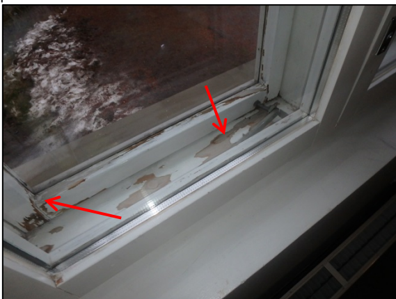
Kuva 42. Karmin alaosassa ja puiteessa on jälkiä veden pääsystä välitilaan.
