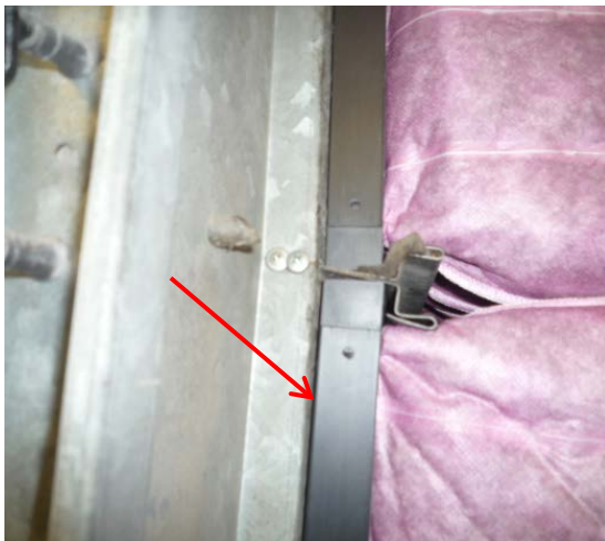
Kuva 133. Tulosuodattimien asennus on epätiivis
