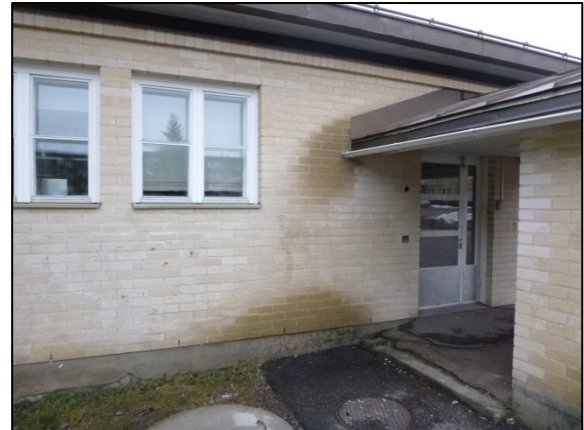
Kuva 25. Räystäsrakenteet ohjaavat katon poistovesiä julkisivurakenteeseen.
