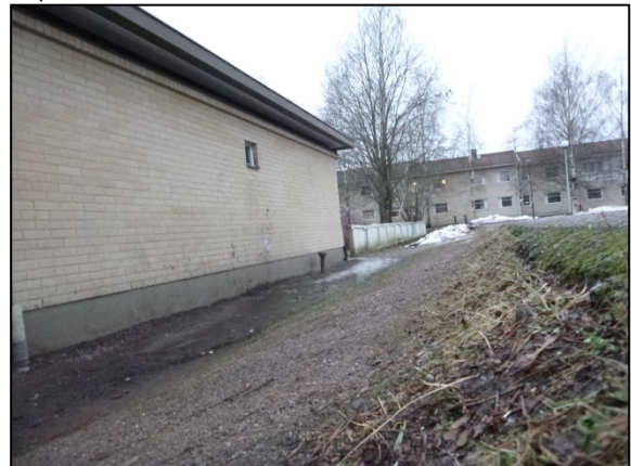
Kuva 9. Maanpinta rakennuksen koillisivulla kaataa rakennukseen päin.
