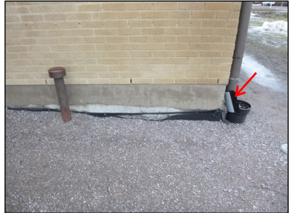
Kuva 5. Patolevy on rikkoutunut. Syöksytorveen on asennettu vedenohjain.
