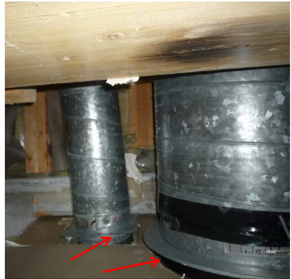
Kuva 161. . Virheellisiä palopeltiasennuksia opetusvälinetilan 119 alakatossa. Pellit asennettu irralleen osastoivasta rakenteesta.
