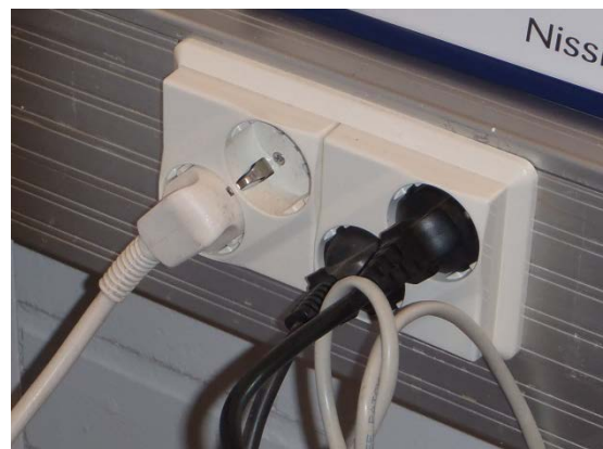
Kuva 193. Rakennusajankohdan jälkeen asennettuja pistorasiakalusteita.
