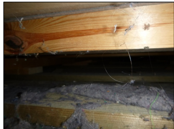
Kuva 16. Rakenteessa on suuria määriä pölyä.
