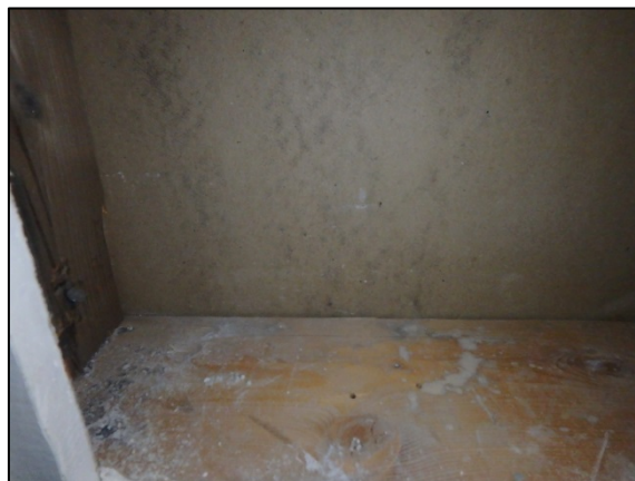
Kuva 78. Kipsilevyn taustapuolella sekä puuosissa on tummentumaa.
