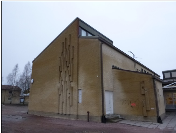
Kuva 24. Rakennuksen päätyjulkisivuun kohdistuu avoimesta maastosta johtuen runsasta kosteusrasitusta.
