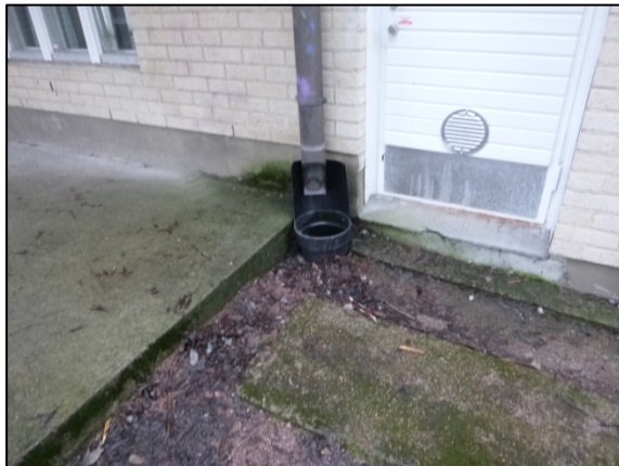
Kuva 8. Sokkelirakenteisiin on kohdistunut pitkäaikaista kosteusrasitusta, vierustäyttö on hienoa hiekkaa/soraa.
