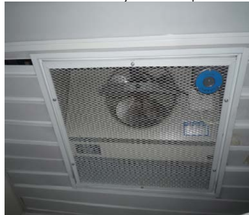
Kuva 174. Kiertoilmalämmitin keittiön eteisessä
