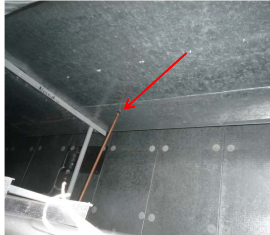
Kuva 130. Kuparisen vedenpoistoputken liitos raitisilmakanavan pohjaan korkealla iv-konehuoneessa
