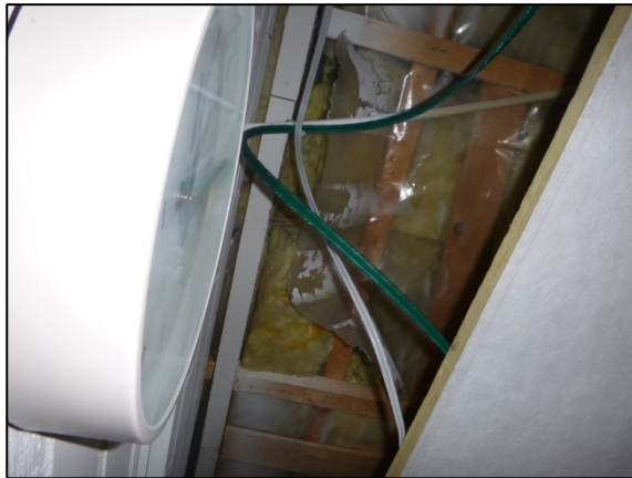
Kuva 92. Yläpohjan muovikalvossa on suuria reikiä läpivientien läheisyydessä.
