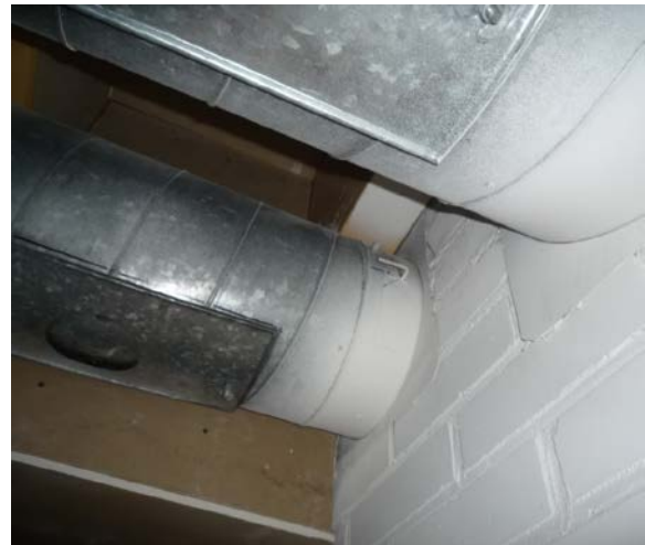
Kuva 159. Oikeaoppisesti kiinni osastoivaan rakenteeseen asennetut palopellit ruokalan alakatossa
