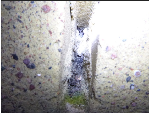
Kuva 28. Muurauksen alaosan tuuletusaukot ovat tukkeutuneita.
