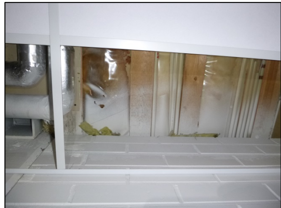
Kuva 126. Muovikalvon päällä on ollut kosteuden aiheuttamien jälkien perusteella pidemmän aikaa vettä.
