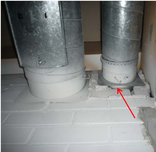
Kuva 160. Ruokalan alakatto, vasemmanpuoleinen palopelti asennettu kiinni osastoivaan rakenteeseen, oikeanpuoleinen asennus virheellinen, pelti irrallaan seinästä
