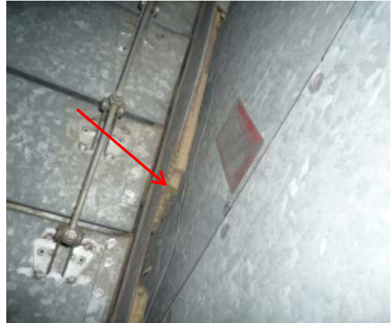
Kuva 136. Suojaamatonta mineraalivillaa LTO-kuution reunalla tuloilmapuolella
