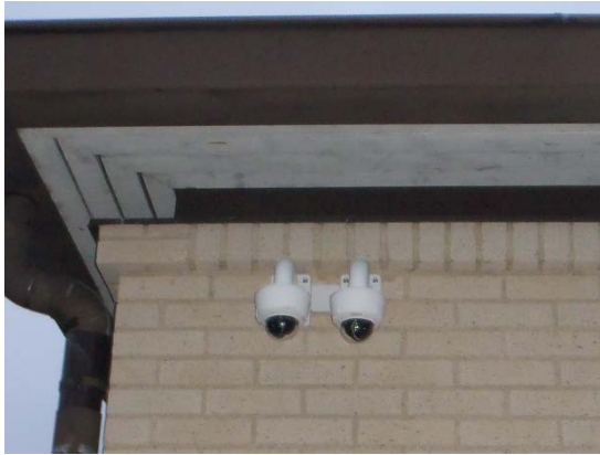
Kuva 206. Valvontakamerat rakennuksen nurkalla.
