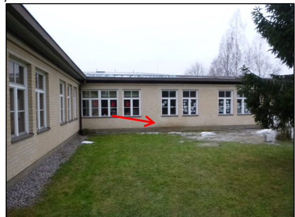
Kuva 27. Tiilimuurauksen alaosassa on kosteuden aiheuttamaa tummumista lähes kaikilla julkisivuilla.
