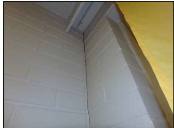
Kuva 74. Tiiliseinien liitoksessa on epätiiveyskohtia.
