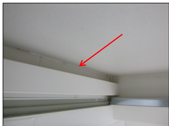
Kuva 71. Luokkatilojen uusien alakattojen yläpuolisten vanhojen kattojen liitoskohdat ovat osin avoimia.
