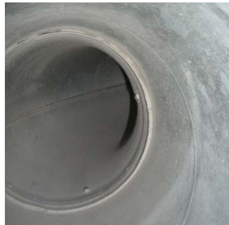
Kuva 157. WC-tila 110, poistoilmakanavassa normaalia pölykertymää
