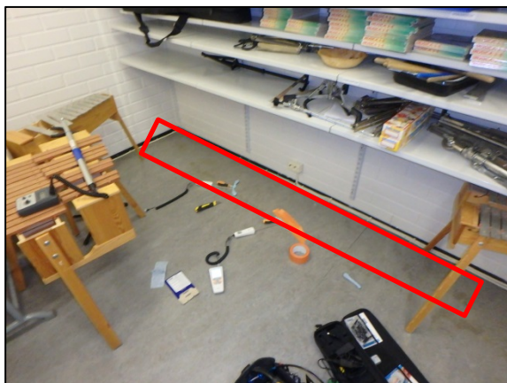
Kuva 10. Tilan 130 lattiapinnoilla havaittiin kohonneita pinta-kosteuden vertailuarvoja sekä pinnoitteessa vauriojälkiä.
