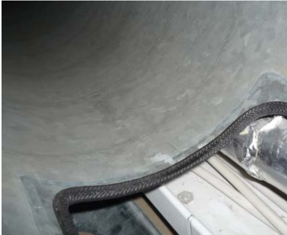
Kuva 154. Luokka 185, tuloilmakanavan pohjalla pinttynyttä likaa, kts. seuraava kuva
