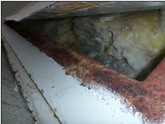
Kuva 30. Liikuntasalin ulko-oven lämmöneristeet ovat aistinvaraisesti arvioituna vaurioituneet.
