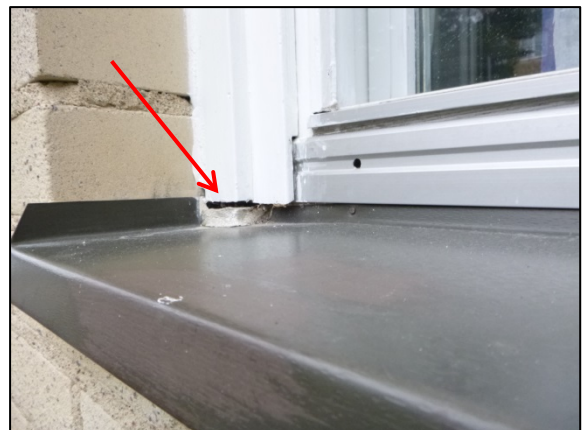
Kuva 43. Vesipeltien kaato on vähäinen. Nurkan tiivistemassaus on osin avonainen.
