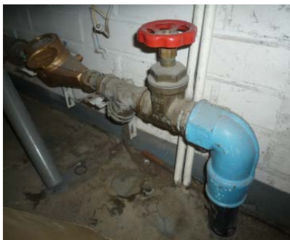
Kuva 175. Tonttivesijohto ja vesimittari
