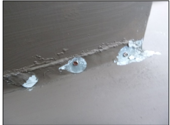
Kuva 109. Läpiviennin alaosassa on kiinnitysruuveja, joiden päälle asennettu tiivistemassa on irronnut.
