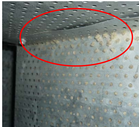
Kuva 150. TF2, äänenvaimennusosassa on reikälevyn takana suojaamatonta mineraalivillaa
