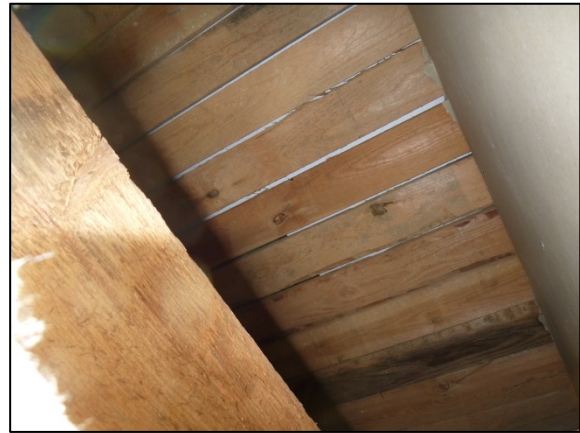
Kuva 120. Rakenneavauskohdalla olevan vesikatteen alapuolelle on havaittavissa osittain asennettu aluskatemuovi laudoitusten välistä.
