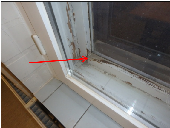
Kuva 40. Ulkopuiteissa on kosteuden aiheuttamia pinnoitevaurioita.
