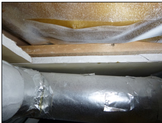
Kuva 127. Yläpohjan lämmöneristeet ovat märkiä.
