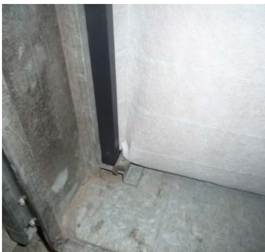
Kuva 139. Poistoilmasuodattimien asennus oli tiivis, merkittäviä ohivuotoja ei havaittu
