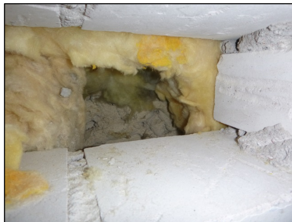
Kuva 57. Kermissä ei ole ylösnostoa. Villaeristeessä on tummentumaa.
