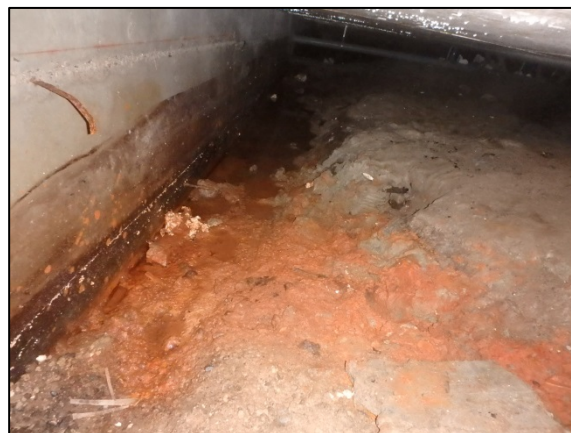
Kuva 11. Alapohjatilassa on veden lammikoitumista sokkelin reunalla.
