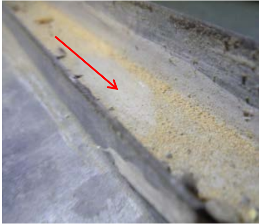
Kuva 135. Pölykertymään tehty pyyhkäisyjälki suodatinkammiossa (siitepölyä)
