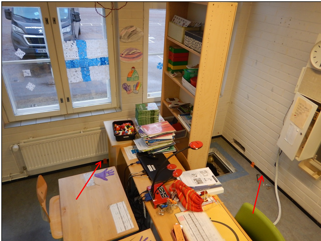
Kuva 20. Tilassa 186 havaittiin yksittäisiä vuotokohtia alapohjarakenteen ja seinän liitoksissa.
