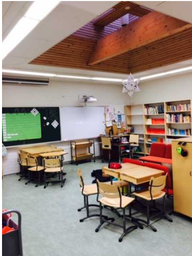
Vanhan siiven kattoikkunat ovat huonokuntoisia
