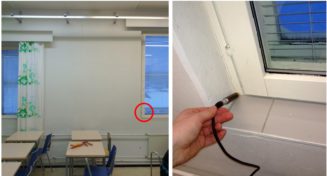
Kuvat 19–20. Auditorion seinässä oli vuotokohta ikkunan nurkassa.
