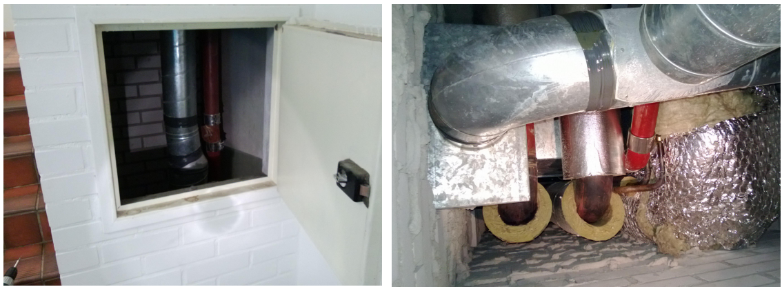
Kuvat 28–29. LVI-kuilu sijaitsi rakennuksen länsiosassa. Kuilussa oli avoimia mineraalivillapintoja.
