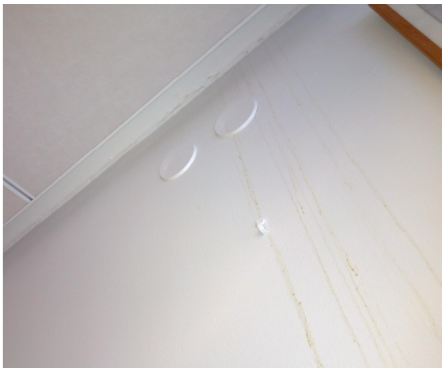
Kuva 24. Vanhan kattovuodon vesivalumajäljet tilassa 321.
