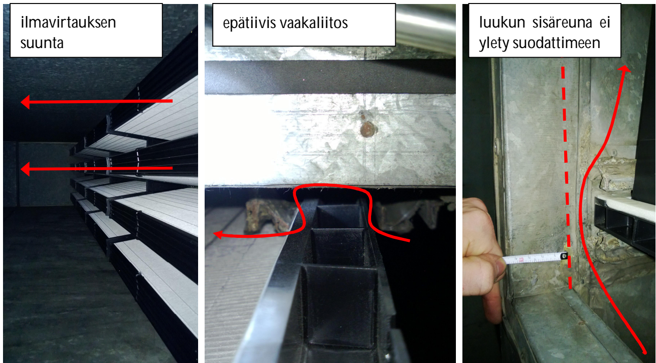
Kuvat 25–27. Tulokanavan suodattimien asennus ei ole reunoilta ilmatiivis.
